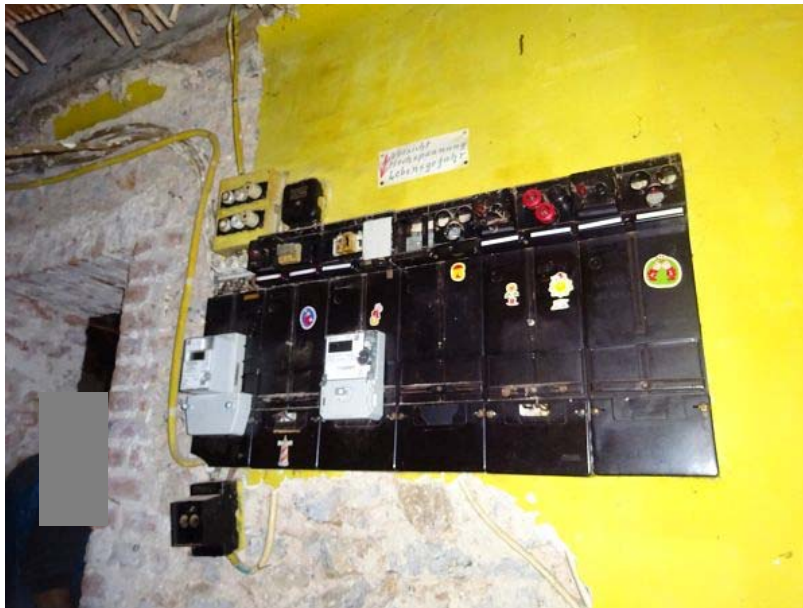
Sicherungen und Zähler DG
