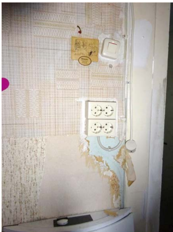
Schalter und Steckdosen provisorisch
