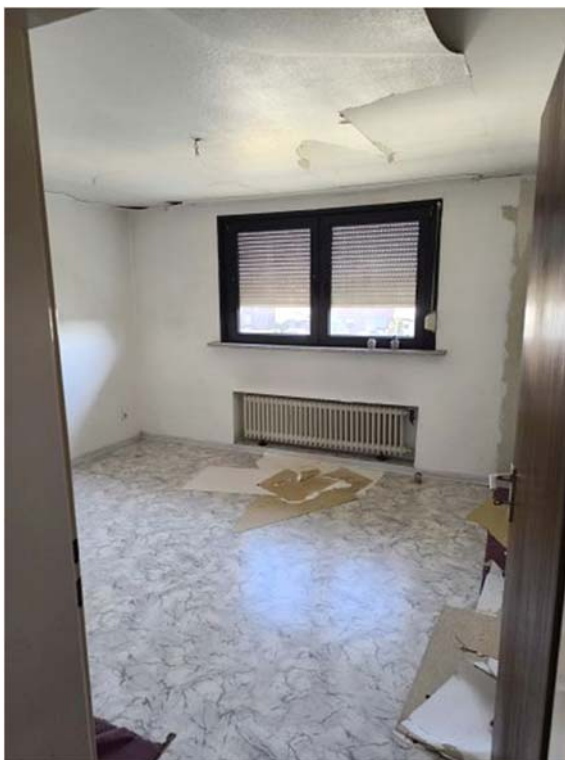
Zimmer DG (Gaube Feuchteschäden)
