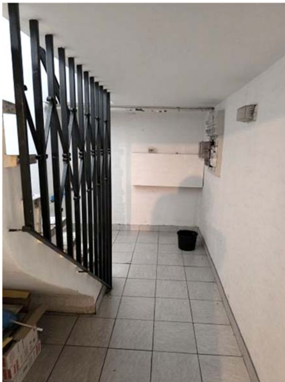
Treppenhaus KG – Zähler / Sicherungen
