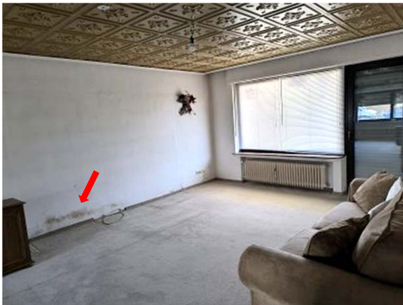
Wohnen / Essen mit Zugang Terrasse (Feuchteschaden Giebelwand)
