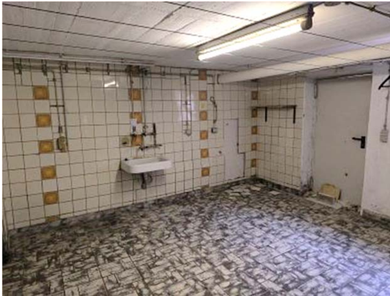
KG Waschküche mit Zugang Außentreppe - Feuchteschäden
