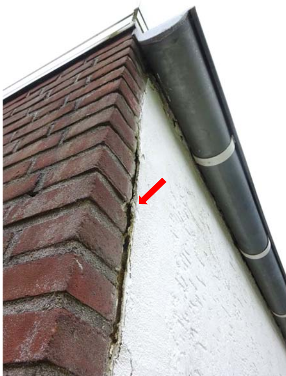
Putzablösung Außenwanddecke Anbau
