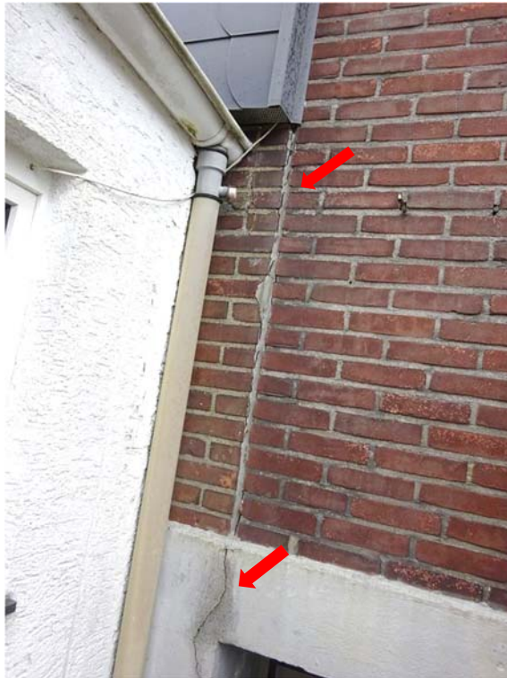
Riss - Anschluss Haupthaus / Anbau
