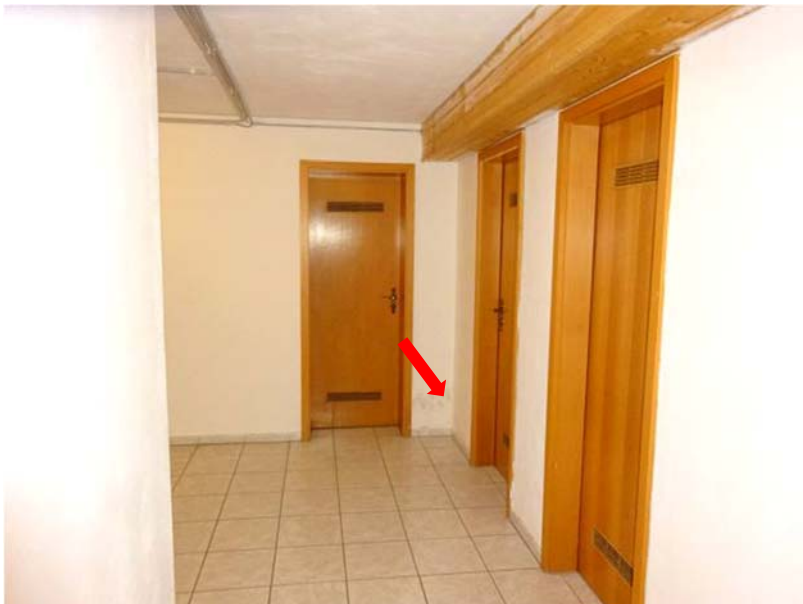
Flur KG (Sockel / Feuchte)
