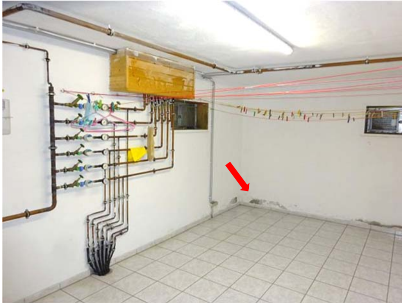
Trockenraum / Hausanschlüsse (Sockel / Feuchte)
