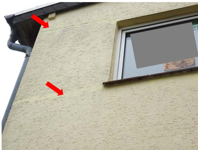
Risse in Fassade OG
