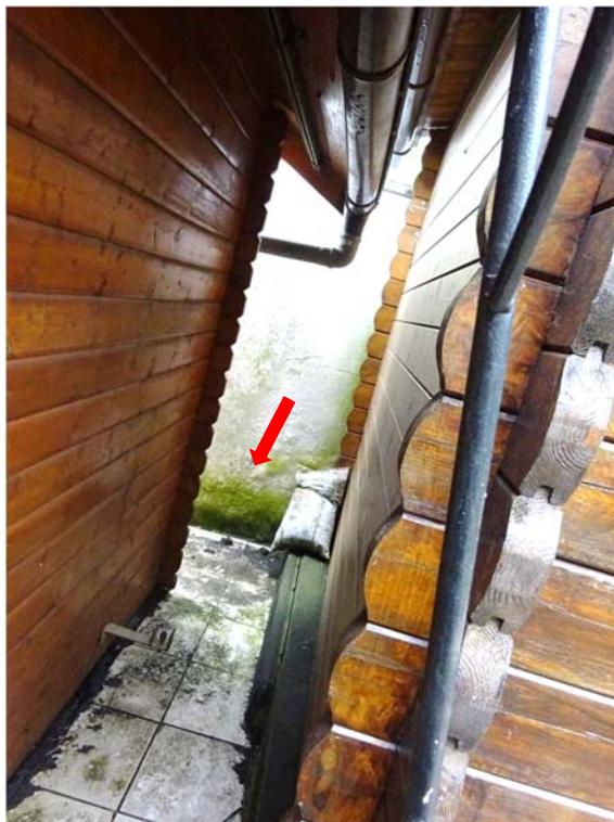
Algenbildung / Feuchte rückwärtige Fassade, Garage Flst. 268
