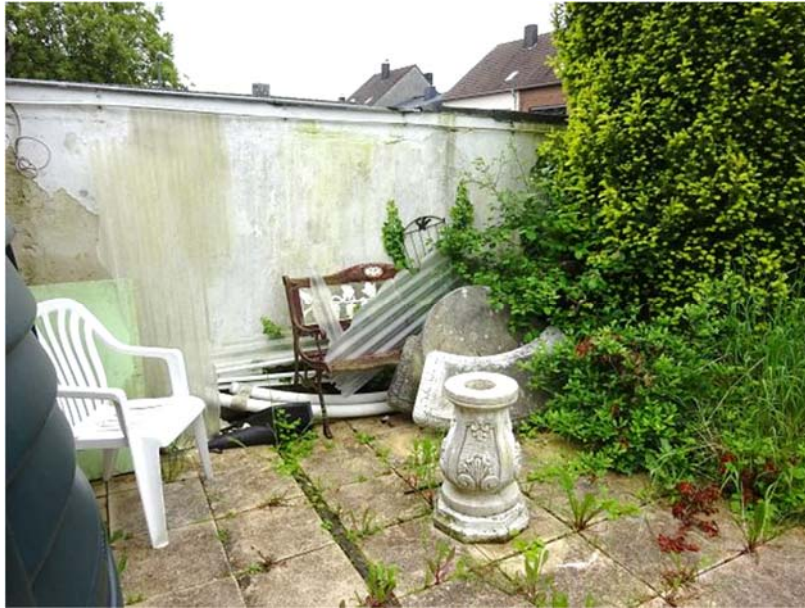
rückwärtige Fassade Garagenblock - Ausblühungen / Feuchte
