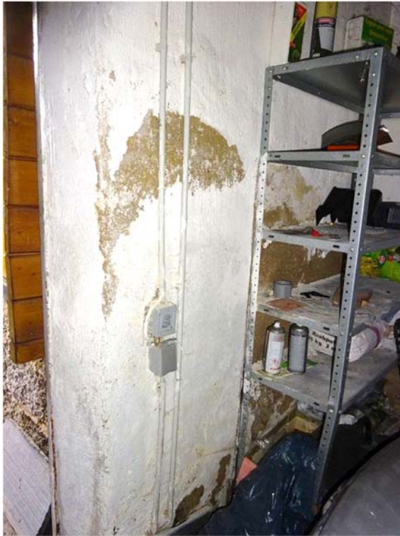
hintere Rückwand / Feuchte
