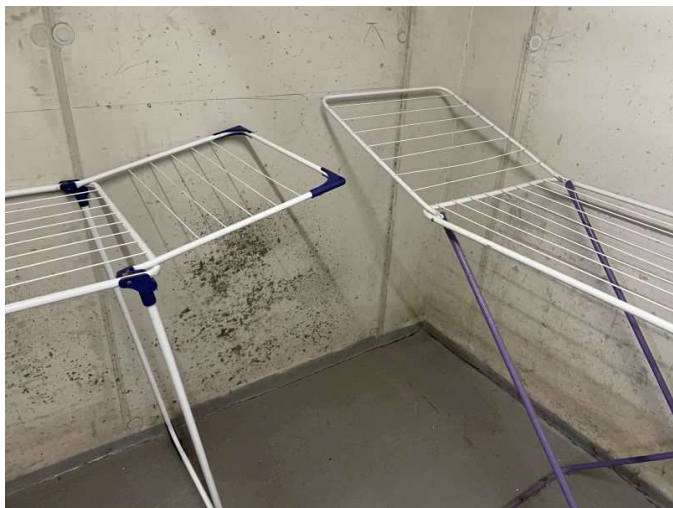
Feuchtigkeitserscheinungen im Kellergeschoss
