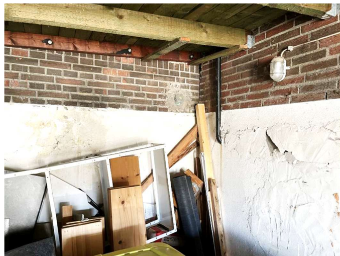
Feuchtigkeitserscheinungen im Garagenanbau
