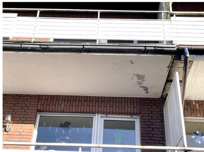
Schaden am Balkon im Obergeschoss
