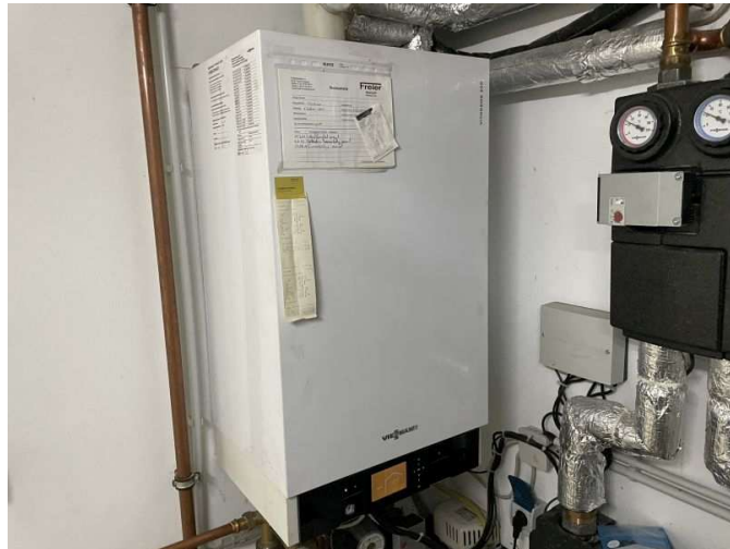
Gastherme im Kellergeschoss
