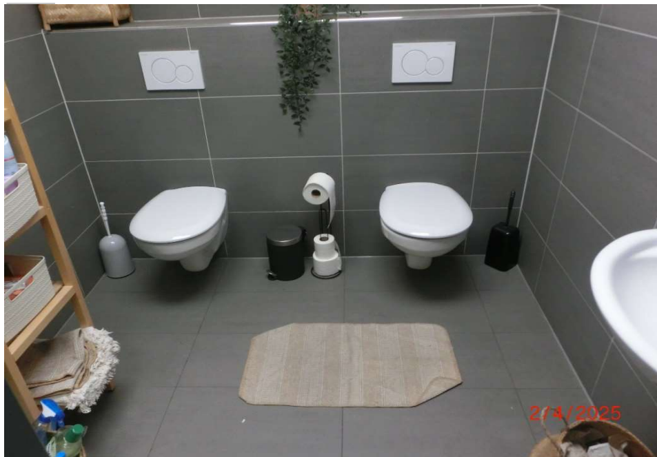
Sanitär in Hallenbereichen
