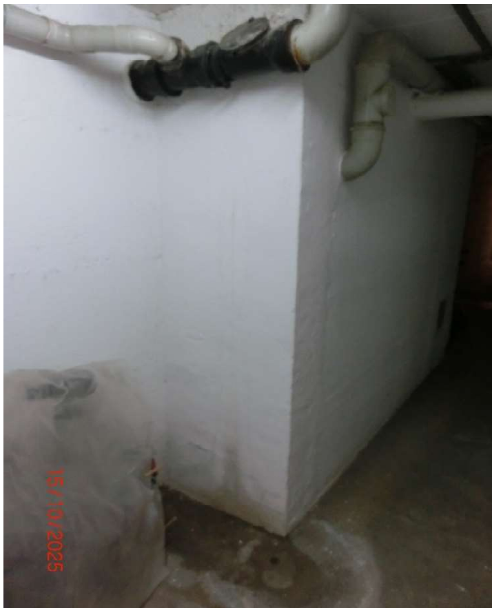
Feuchtstelle im KG
