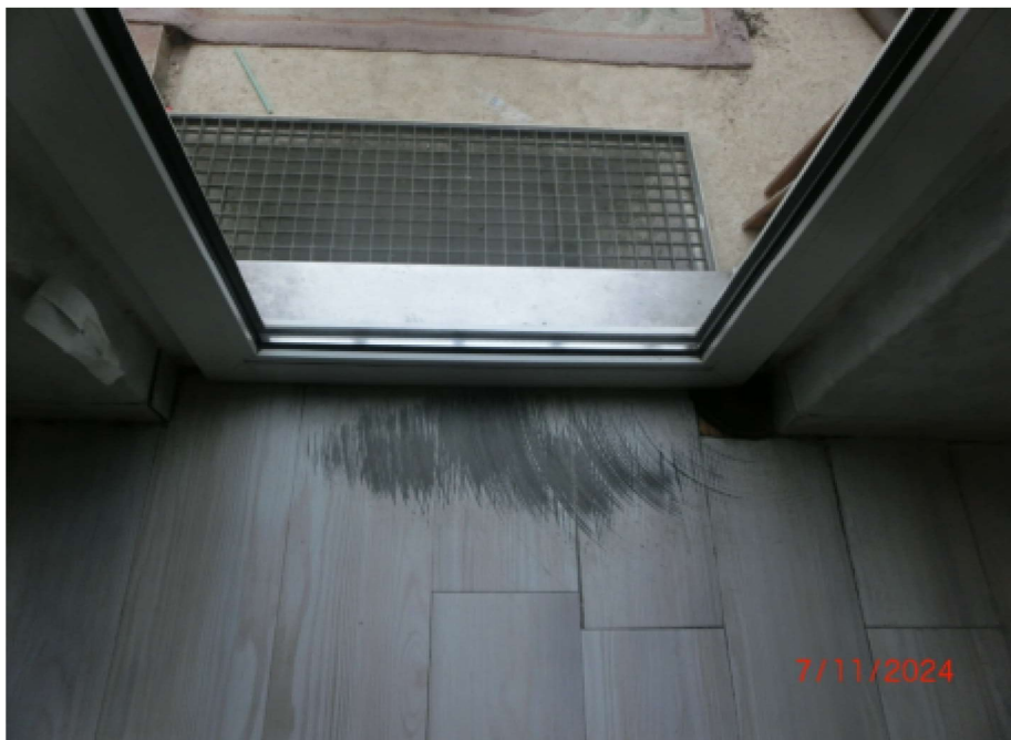
Rollläden und Schleifspuren
