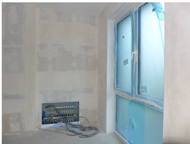
Heizverteilerkasten im Kinderzimmer
