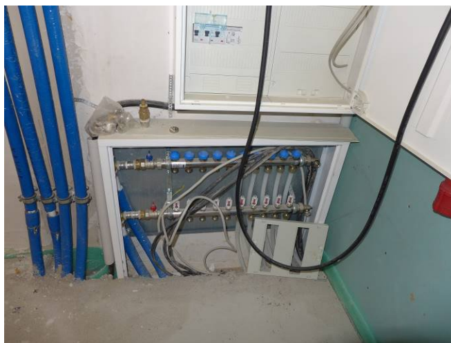
Wärmeverteilerkasten FB-Heizung KG
