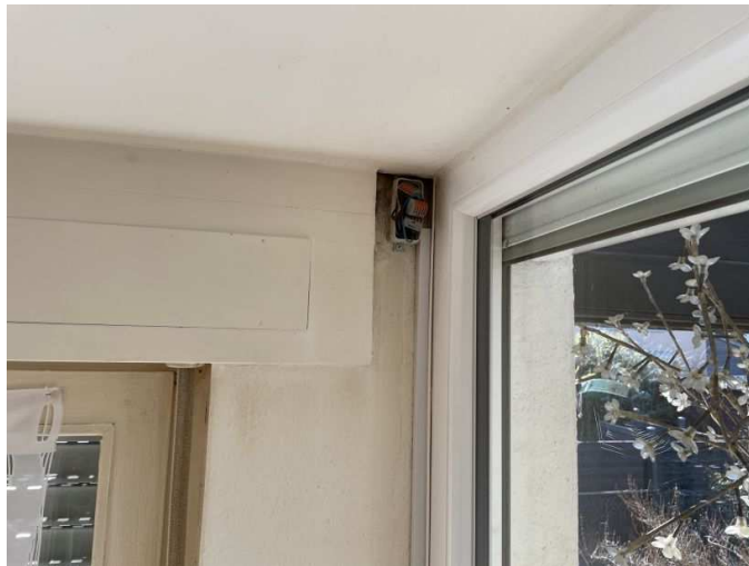
Nicht ordnungsgemäß ausgeführter Elektrorollladenantrieb
