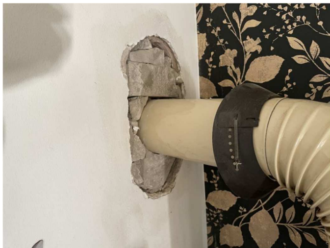
Nicht ordnungsgemäß geschlossener Wanddurchbruch
