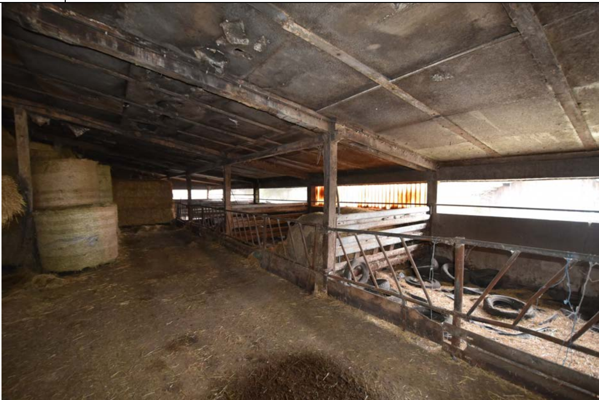
Bild 38 Blick in den teilweise leerstehenden Laufstall / Rinderstall im östlichen Teil des Wirtschaftsgebäudes
