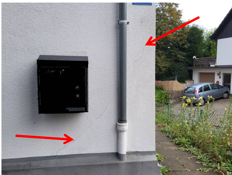
Riss im unteren Bereich Südseite/ Ecke Ostseite
