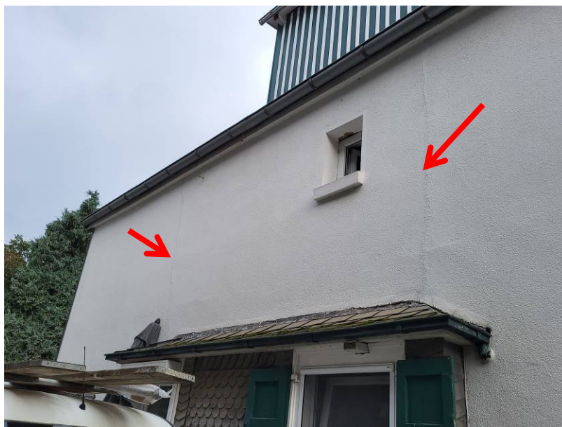
Risse mit Putzaufwölbung Südfassade
