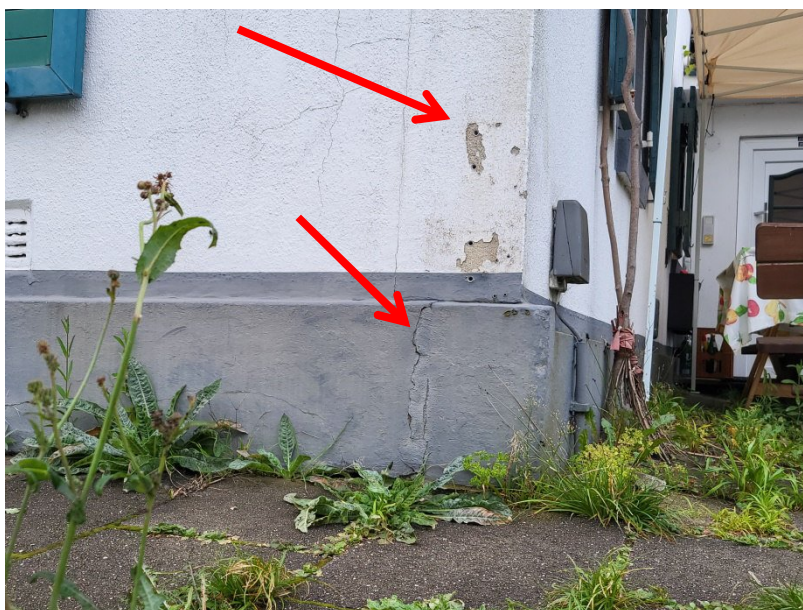
Risse Ecke Ostseite im unteren Bereich
