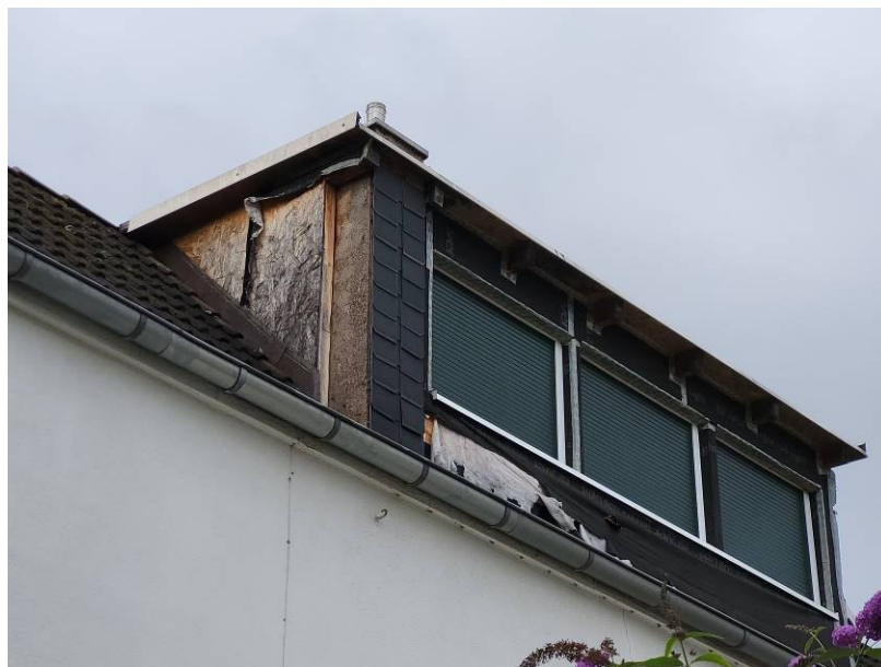
Dachgaube Nordseite mit fehlender Verkleidung
