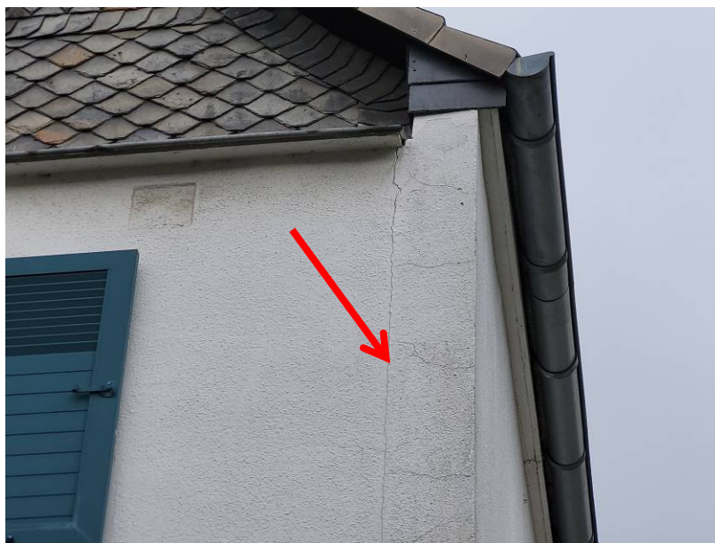
Risse Ecke Ostseite im oberen Bereich
