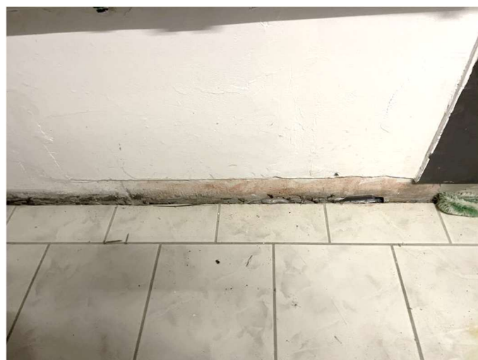
Feuchtigkeitserscheinungen im Kellergeschoss
