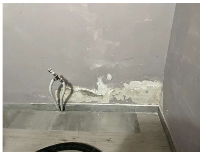
Feuchtigkeitserscheinungen im Kellergeschoss
