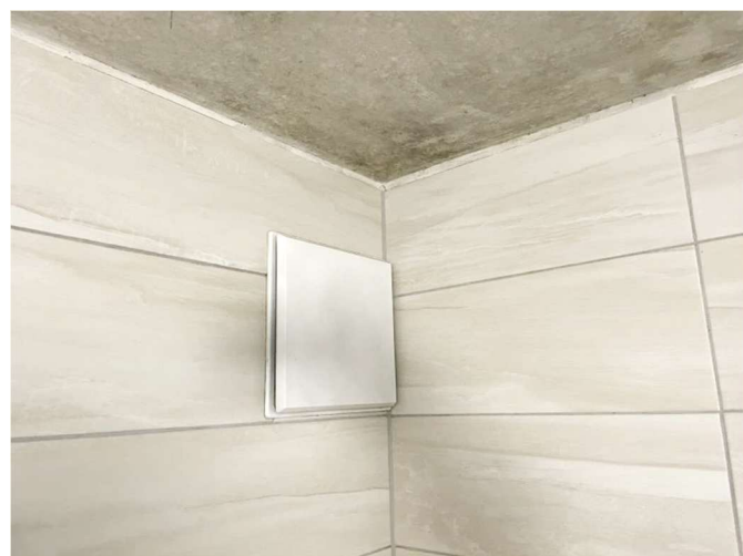
Feuchtigkeitsschäden in der Wohnung Nr. 2 im OG
