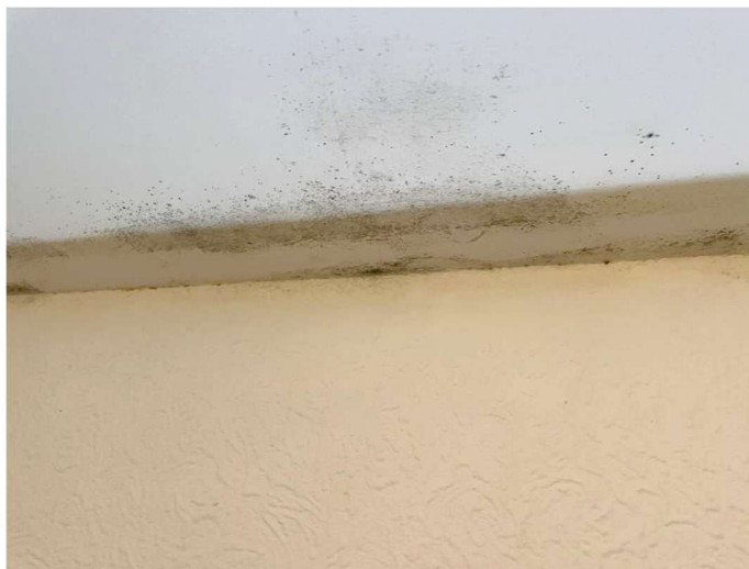
Feuchtigkeitsserscheinungen in der Wohnung Nr. 2 im OG
