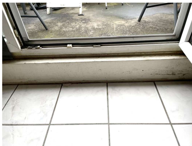
Feuchtigkeitsercheinungen in der Wohnung Nr. 3 im DG
