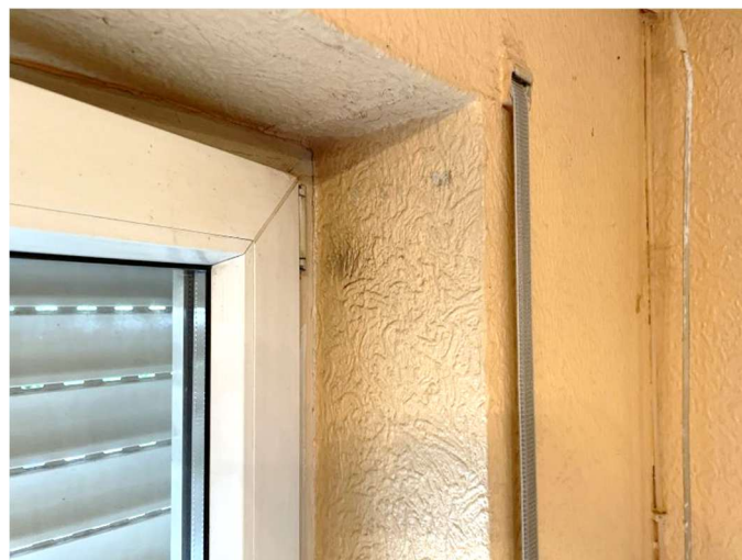
Feuchtigkeitsserscheinungen in der Wohnung Nr. 2 im OG
