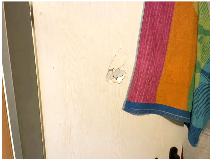
Türschaden in der Wohnung Nr. 3 im DG
