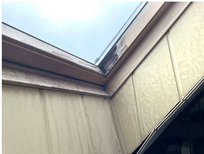
Feuchtigkeit im Dachflächenfenster im Treppenhaus
