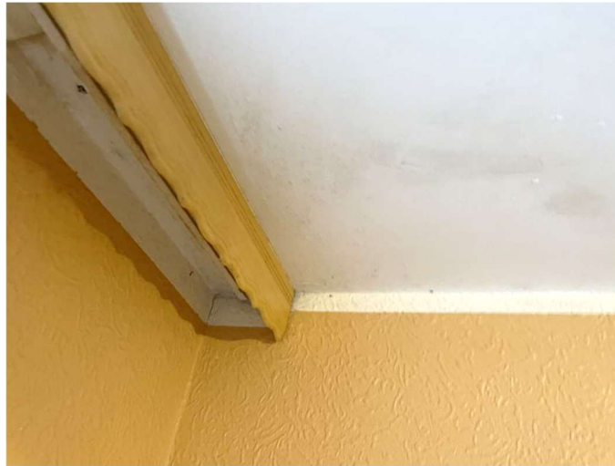
Feuchtigkeitsserscheinungen in der Wohnung Nr. 2 im OG
