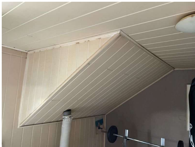
Feuchtigkeitsercheinungen in der Wohnung Nr. 3 im DG
