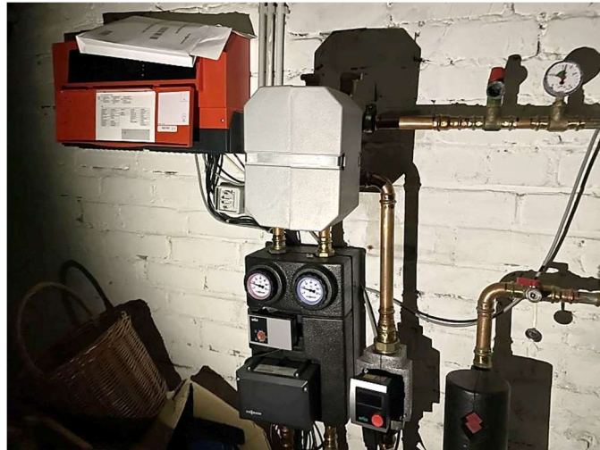
Technik im Kellergeschoss
