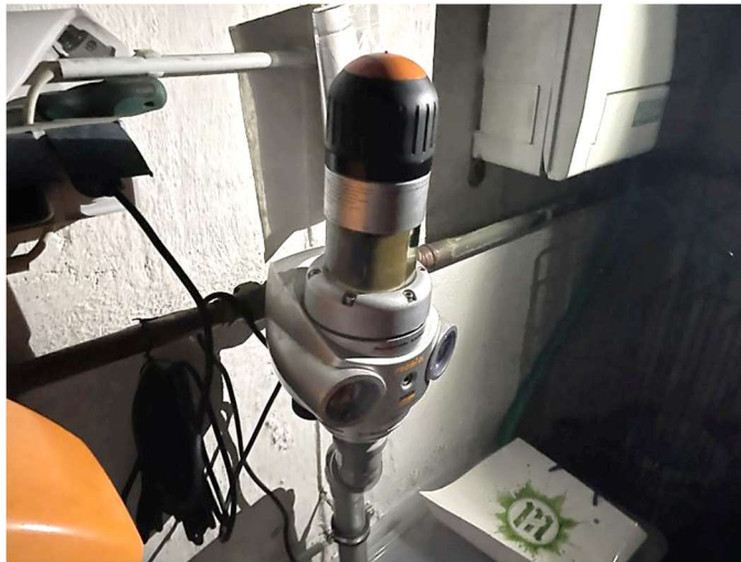
Technik im Kellergeschoss
