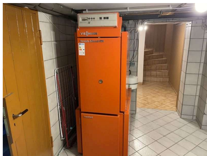
Heizungsanlage aus dem Jahr 1994
