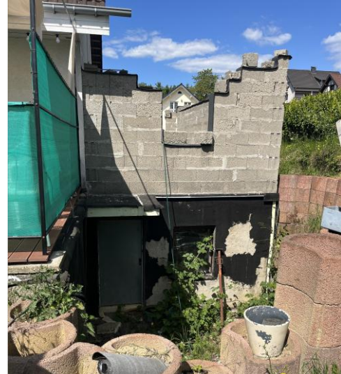
rückwärtige Ansicht nicht fertiggestellte Garage
