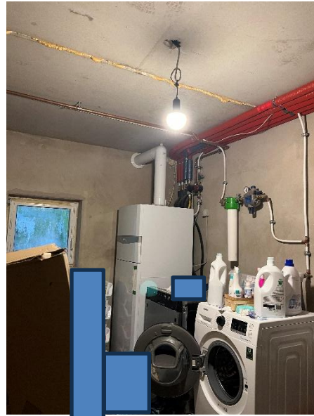
Heizungsanlage im KG
