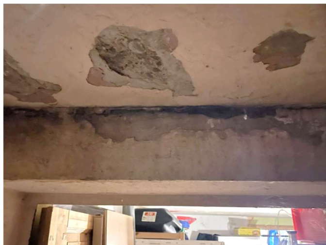
Feuchtigkeitsschäden im Kellergeschoss
