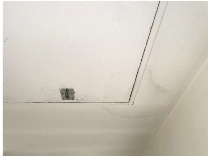
Feuchtigkeitserscheinungen an der Dachgeschossdecke
