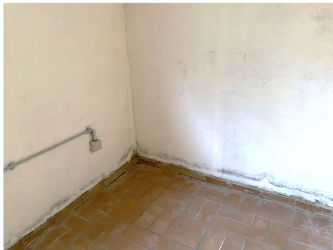
Feuchtigkeitserscheinungen im Kellergeschoss
