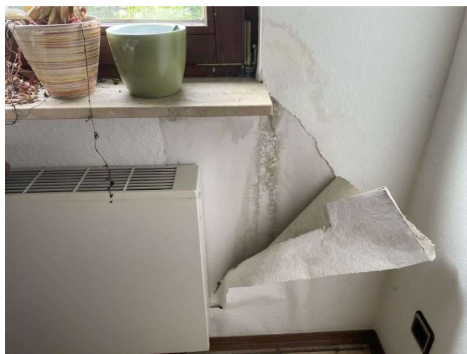
Feuchtigkeitserscheinungen im Wohnzimmer
