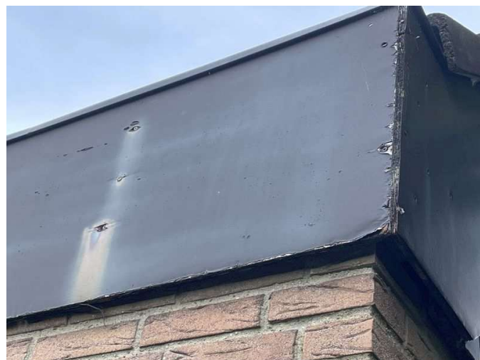
Instandsetzungsbedarf am Dachrandprofil
