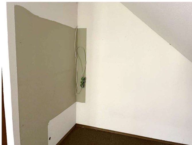
Instandsetzungsbedarf im Dachgeschoss
