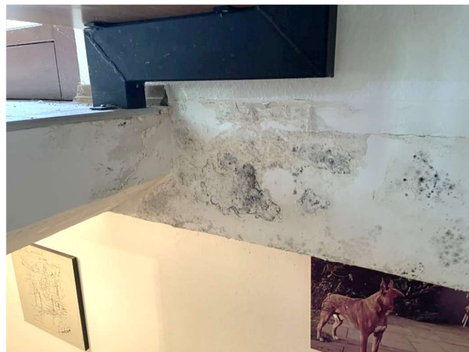
Feuchtigkeitserscheinungen im Treppenbereich
