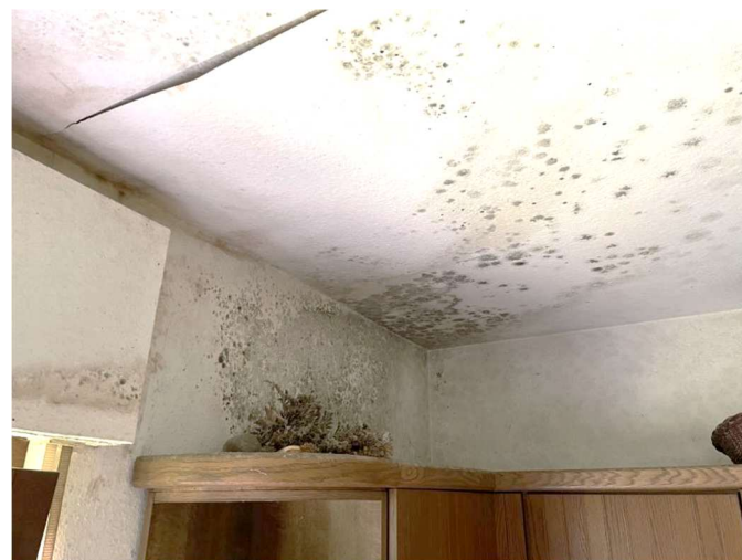
Feuchtigkeitserscheinungen in der Küche
