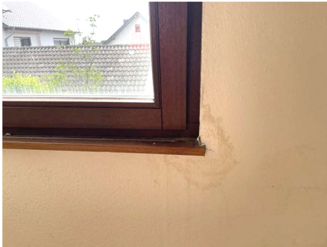
Feuchtigkeitserscheinungen im Dachgeschoss
