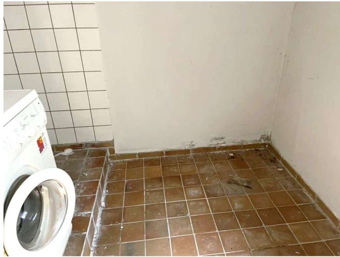
Feuchtigkeitserscheinungen im Kellergeschoss
