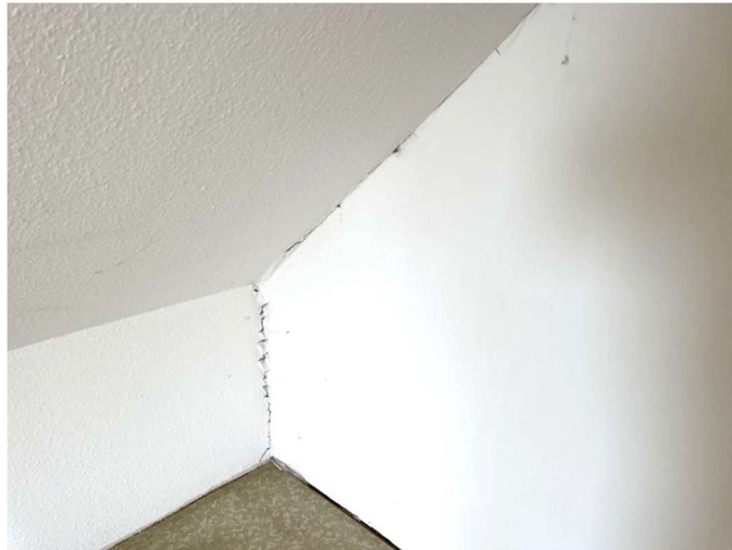
Instandsetzungsbedarf im Dachgeschoss
