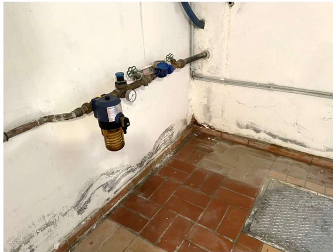
Feuchtigkeitserscheinungen im Kellergeschoss
