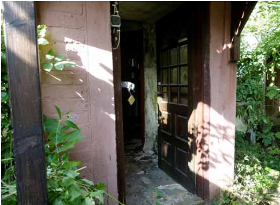
Eingangsbereich des abbruchreifen Hauses „Heidestraße 5a“
