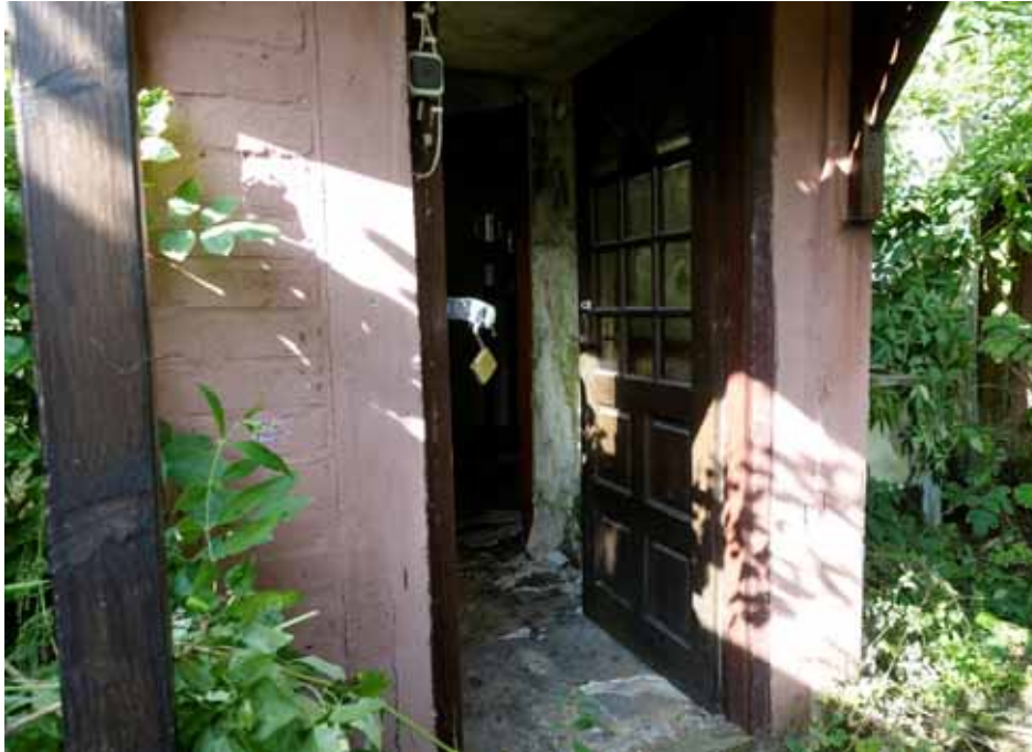
Eingangsbereich des abbruchreifen Hauses „Heidestraße 5a“
