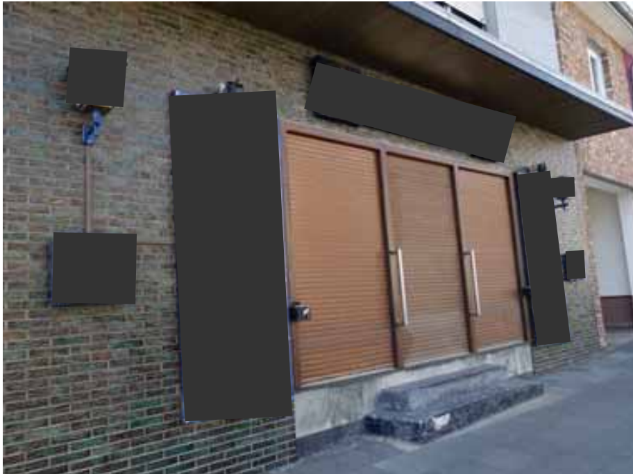
Haupteingang der Gaststätte, stellenweise beschädigte Eingangstreppe
