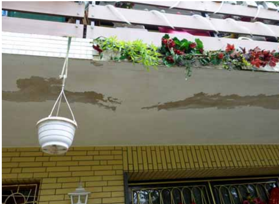
Feuchtigkeitsschäden unterhalb der Loggia
