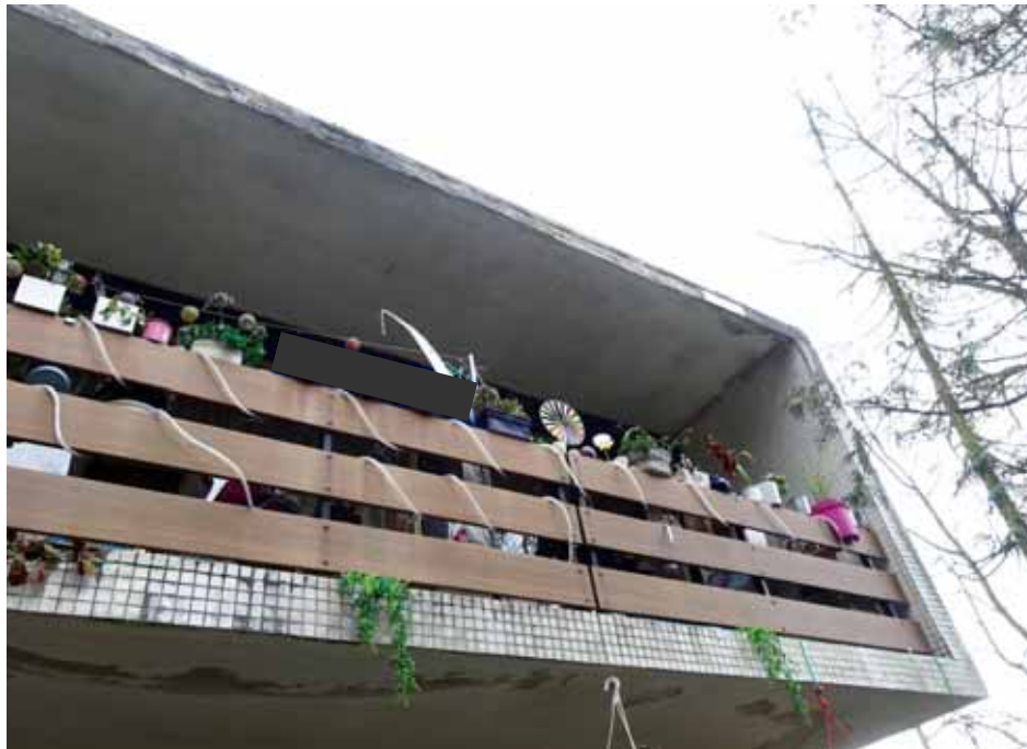
Schäden im Bereich der Loggia
