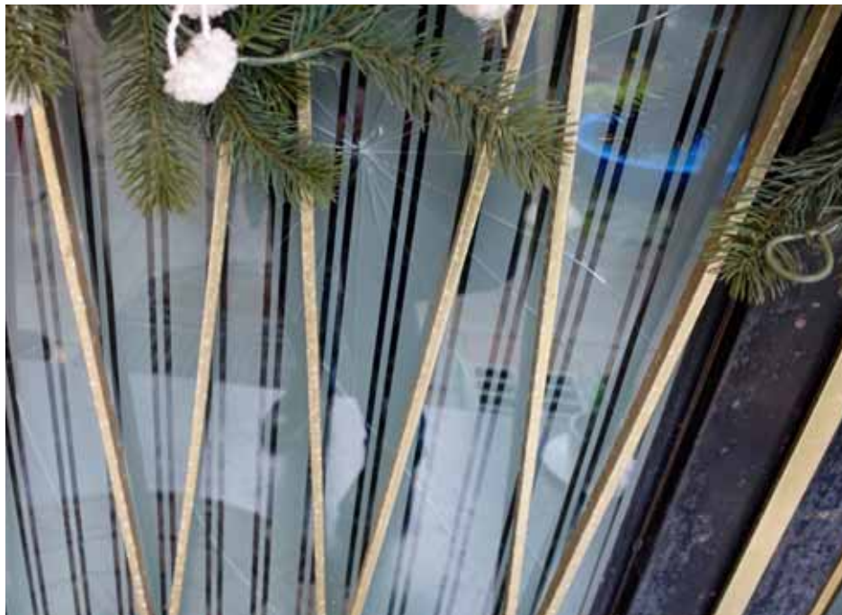
stellenweise beschädigtes Eingangstürelement
