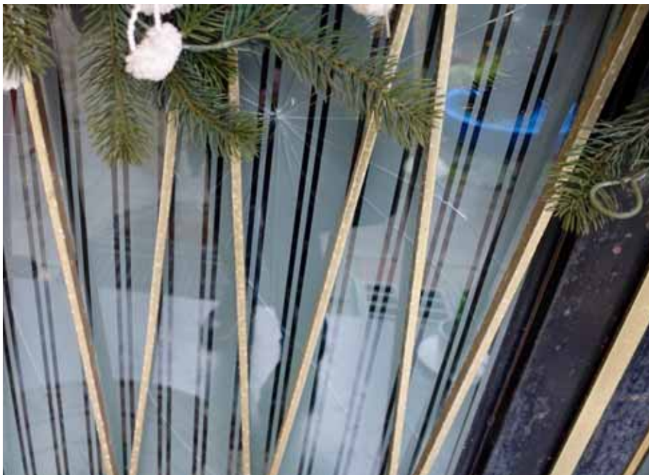
stellenweise beschädigtes Eingangstürelement
