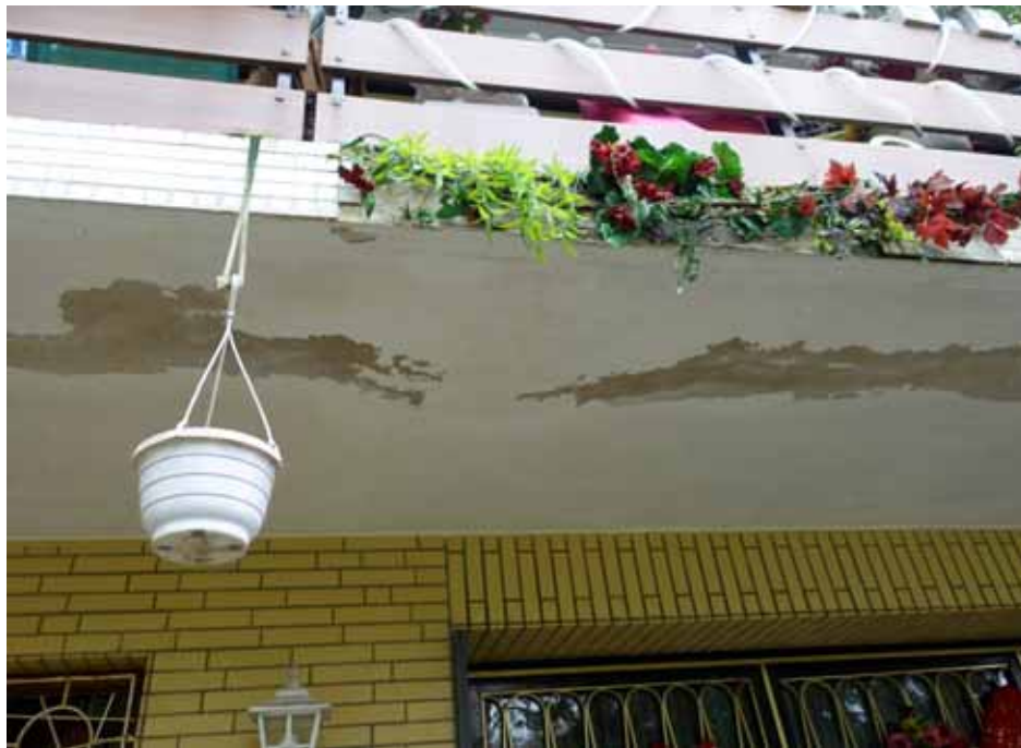
Feuchtigkeitsschäden unterhalb der Loggia
