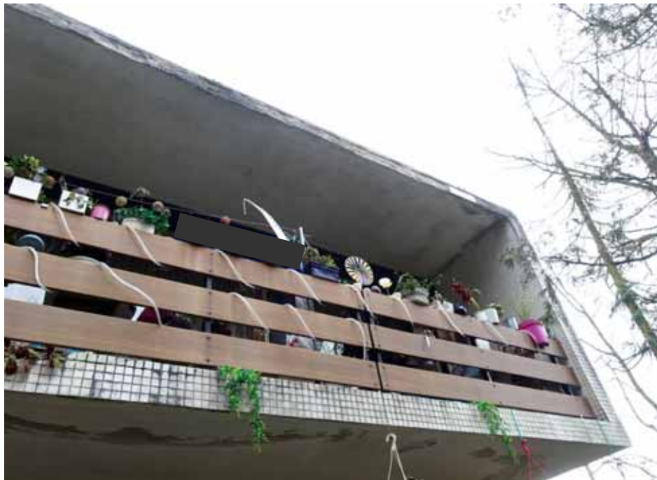
Schäden im Bereich der Loggia
