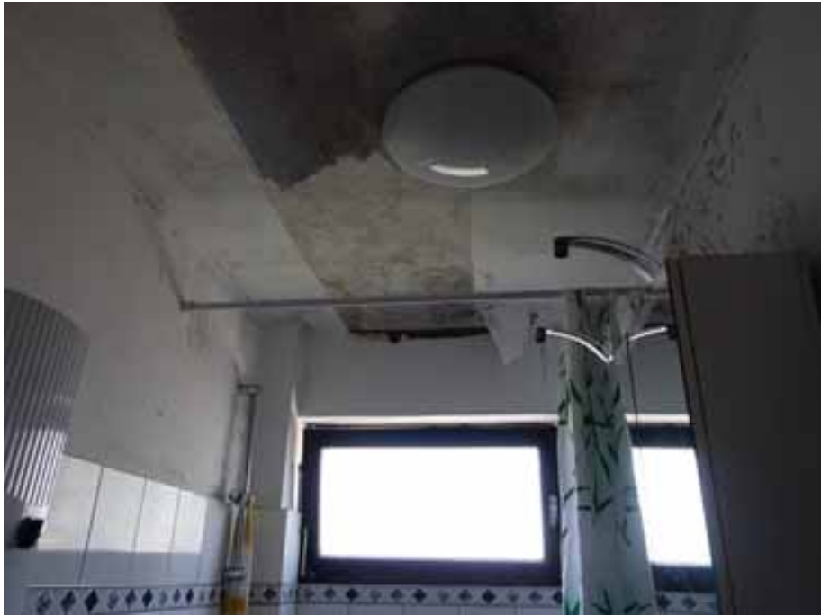
Feuchtigkeitsschäden in den Bädern des Erd- und Obergeschosses
