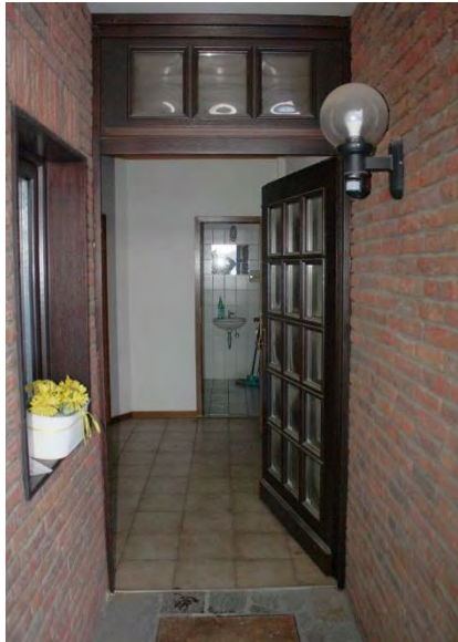
links Beschädigung Fassade
