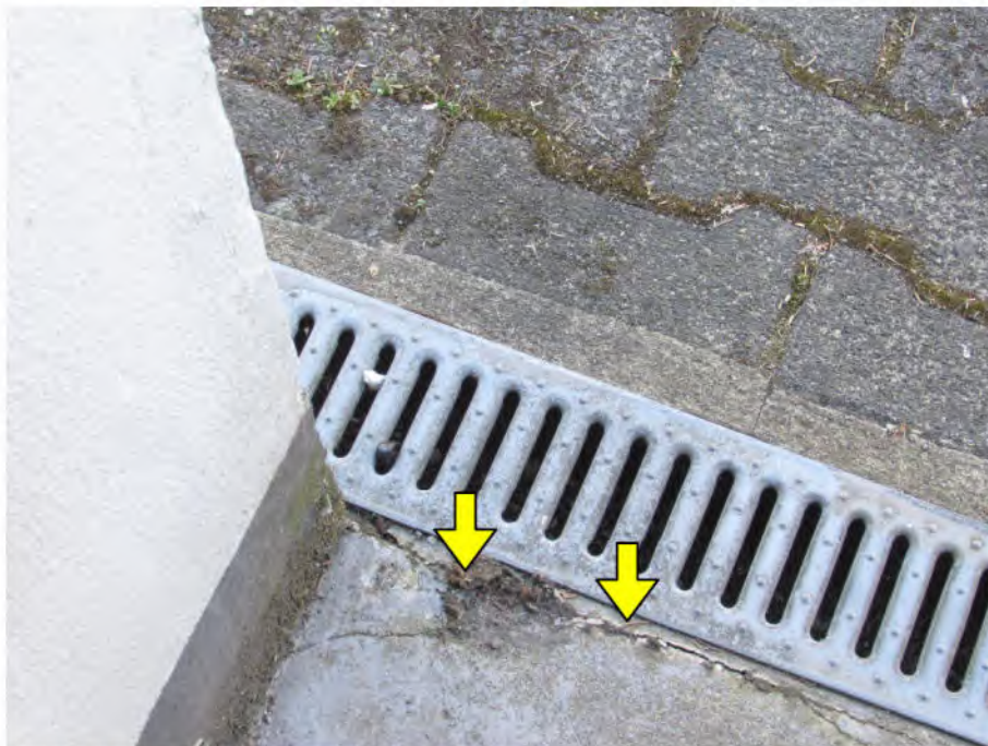
Foto 14: PKW-Garage: Beschädigungen im Bodenbereich
