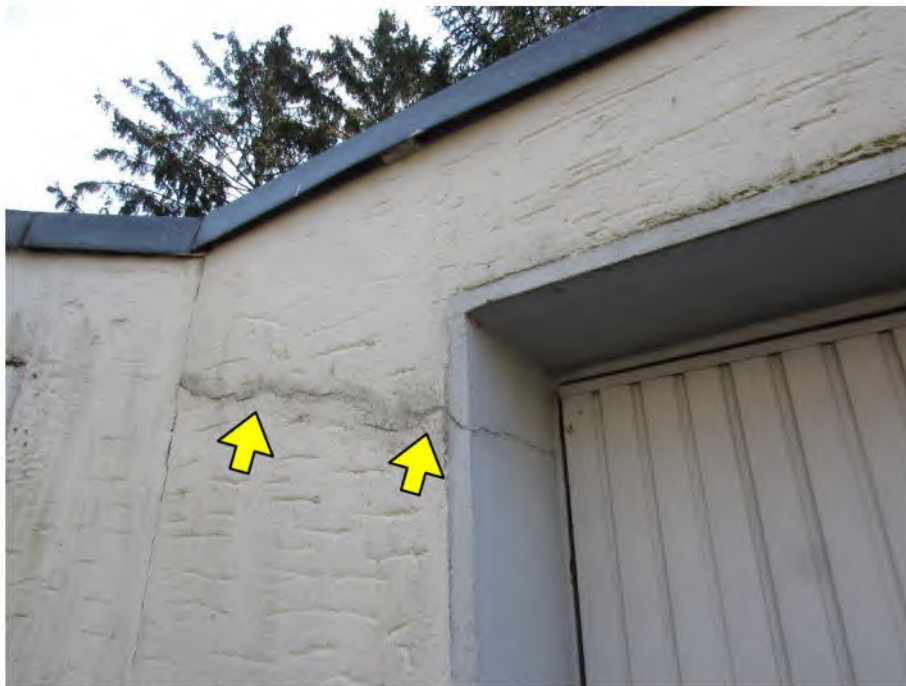
Foto 10: PKW-Garagen: fleckige Fassade, Risse
