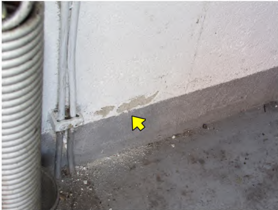
Foto 13: PKW-Garage: Feuchtigkeit im unteren Wandbereich
