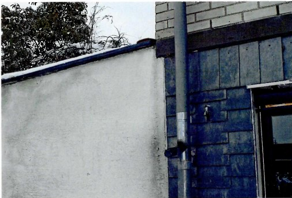
Bild 72 Weitere Nässeschäden neben dem Laden
