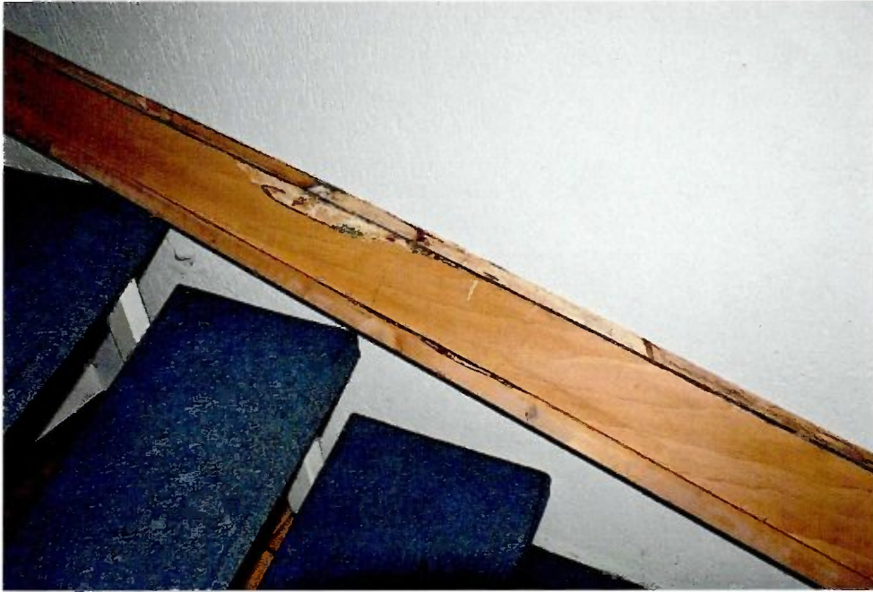
Bild 77 Feuchteschaden Bereich Kellerinntreppe
