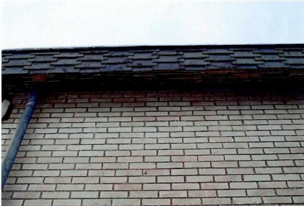
Bild 67 Beispiel für Witterungsschäden am Holzwerk des Daches
