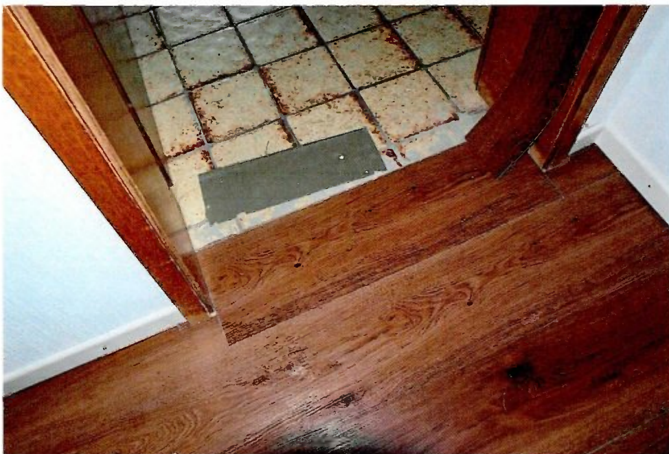
Bild 80 Mangelhafter Übergang Fliesen zu Parkett
