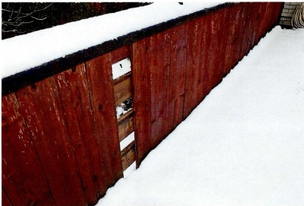
Bild 74 Beispiel für Schäden an der Terrassenverkleidung
