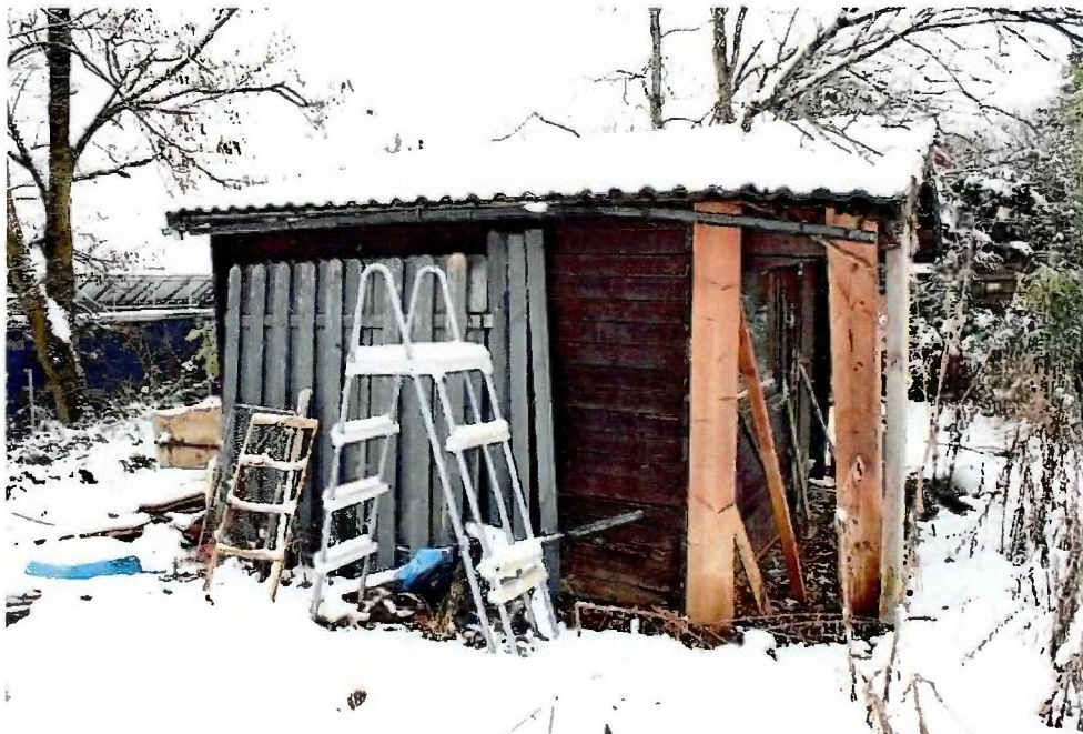
Bild 82 Schäden am Gartenhaus zur WE 1
