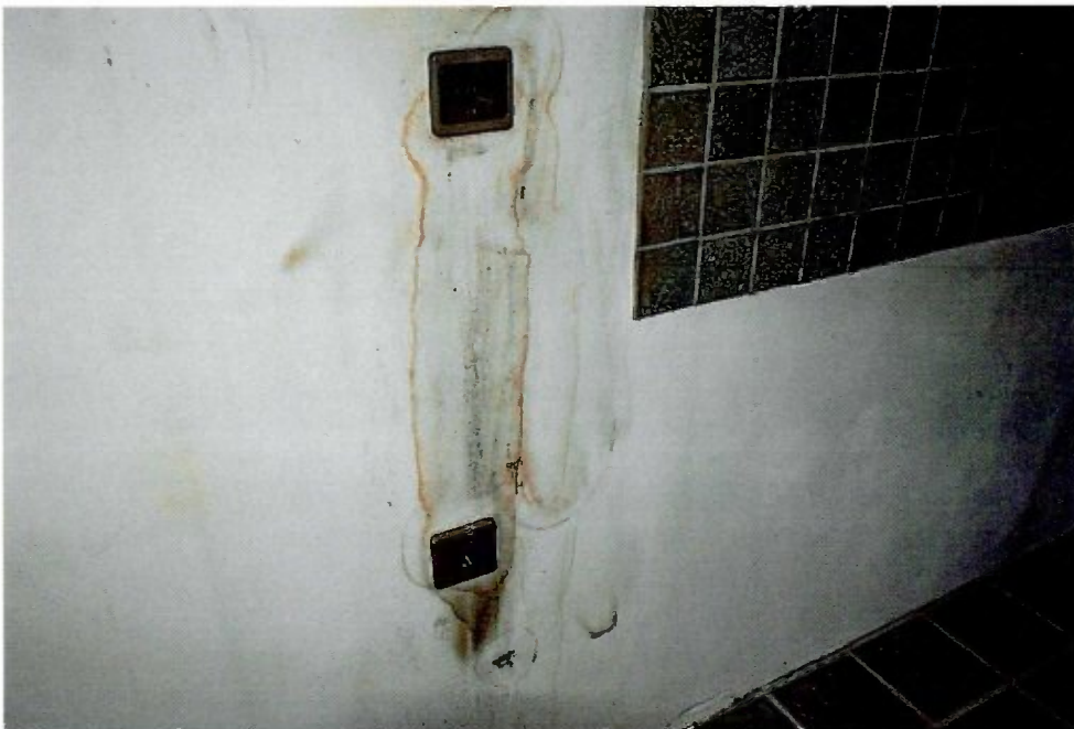
Bild 78 Wasserschaden in der Küche auf der Schrankseite
