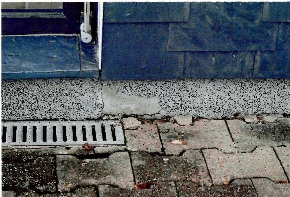
Bild 70 Schäden am Sockel im Bereich des Ladeneingangs UG
