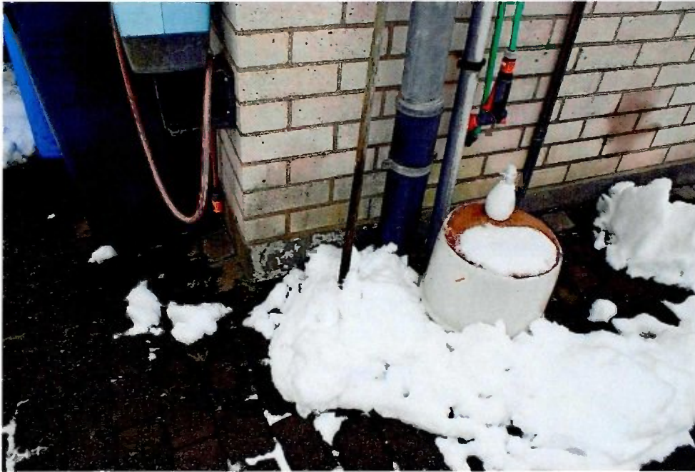
Bild 73 Beispiel für Feuchteschäden Sockel EG frontseitig
