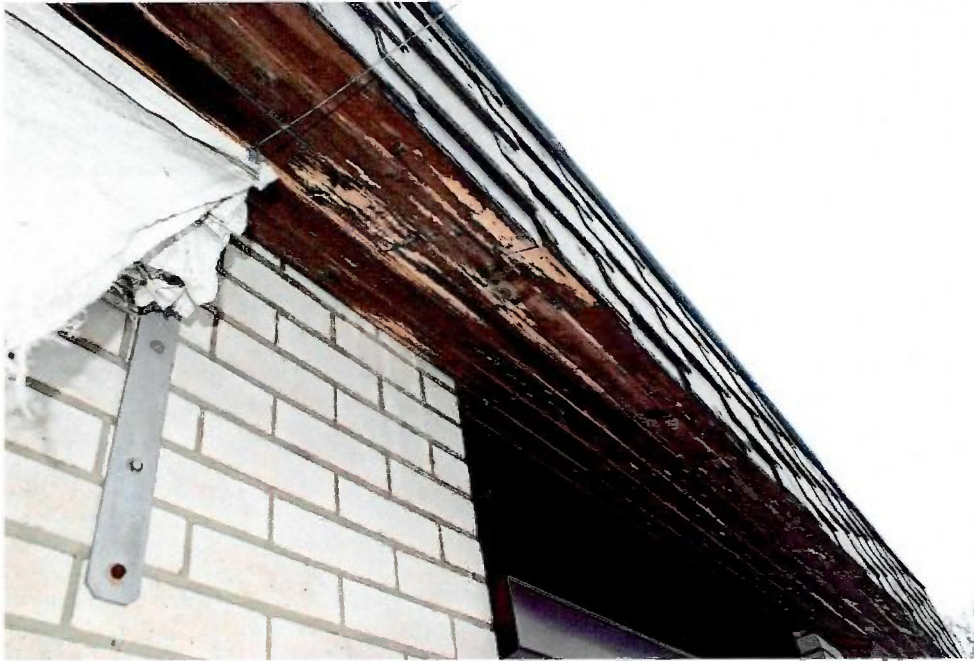
Bild 69 Starke Nässeschäden der Holzverkleidung
