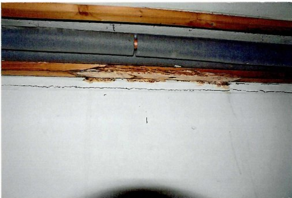
Bild 76 Risse und Feuchteschäden im Vorraum des KG
