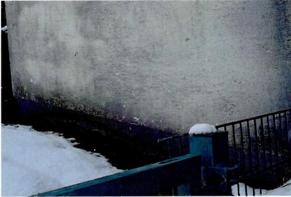
Bild 71 Feuchteschäden an der Wand neben dem Gartenzugang
