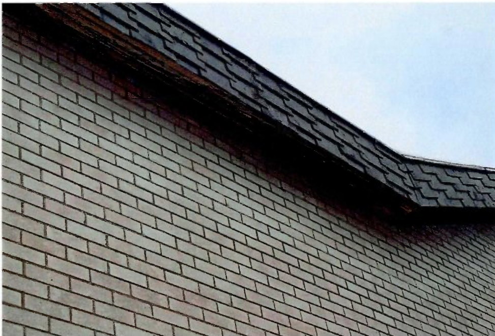
Bild 68 Weiter Schäden Holzwerk und an der Gesimsverkleidung
