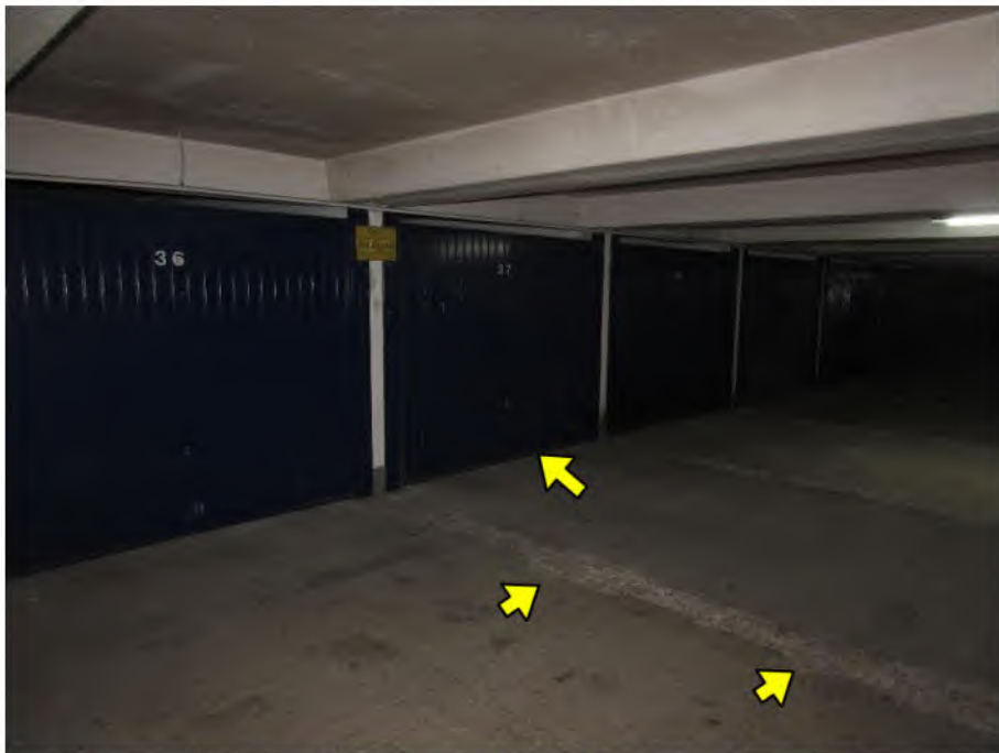
Foto 18: Tiefgarage, obere Ebene: tlw. schadhafter Betonboden Garagenbox Nr. 37
