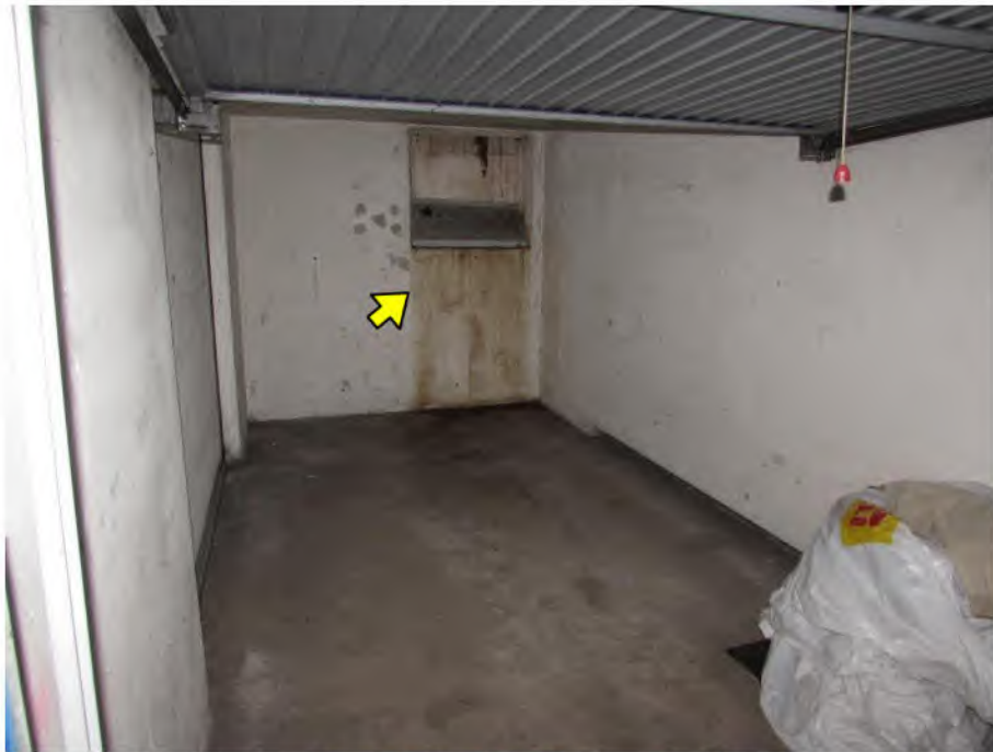
Foto 19: Garagenbox Nr. 37: durch Lüftungsschacht eindringende Feuchtigkeit
