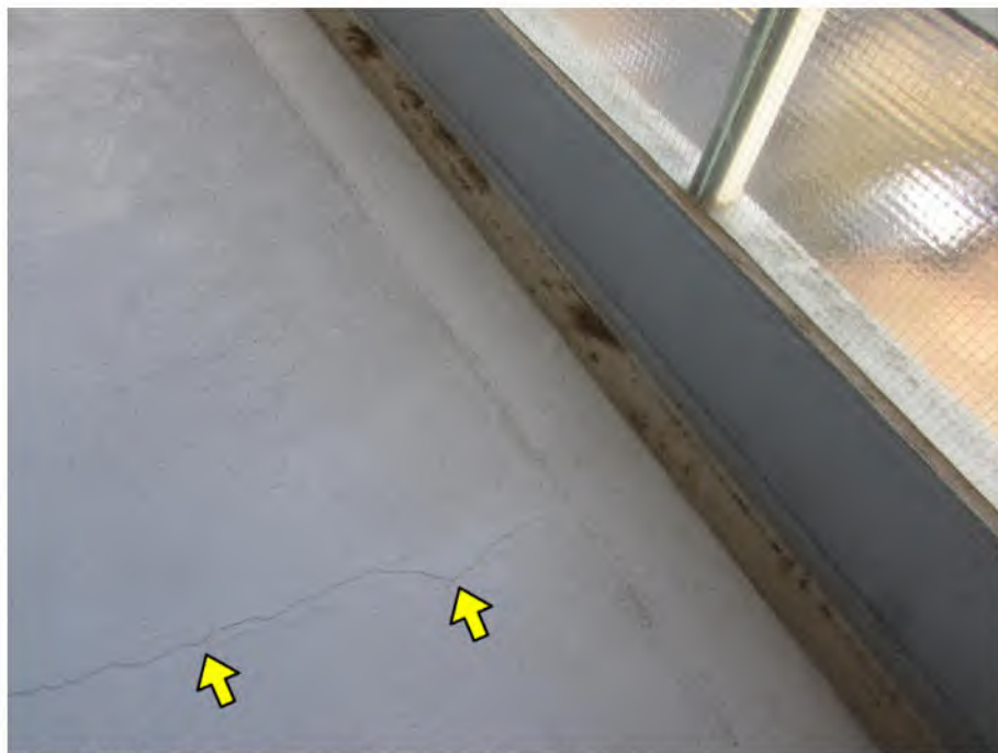
Foto 12: Balkon: Risse im Bodenbereich
