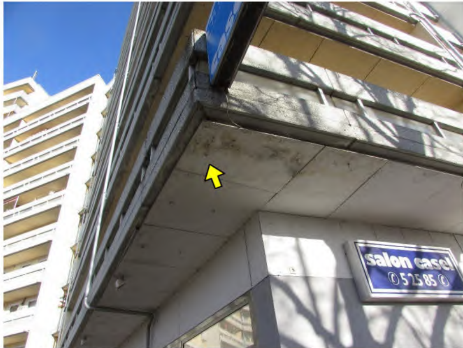
Foto 3: tlw. Feuchtigkeitsflecken im Bereich der Untersicht der Balkone
