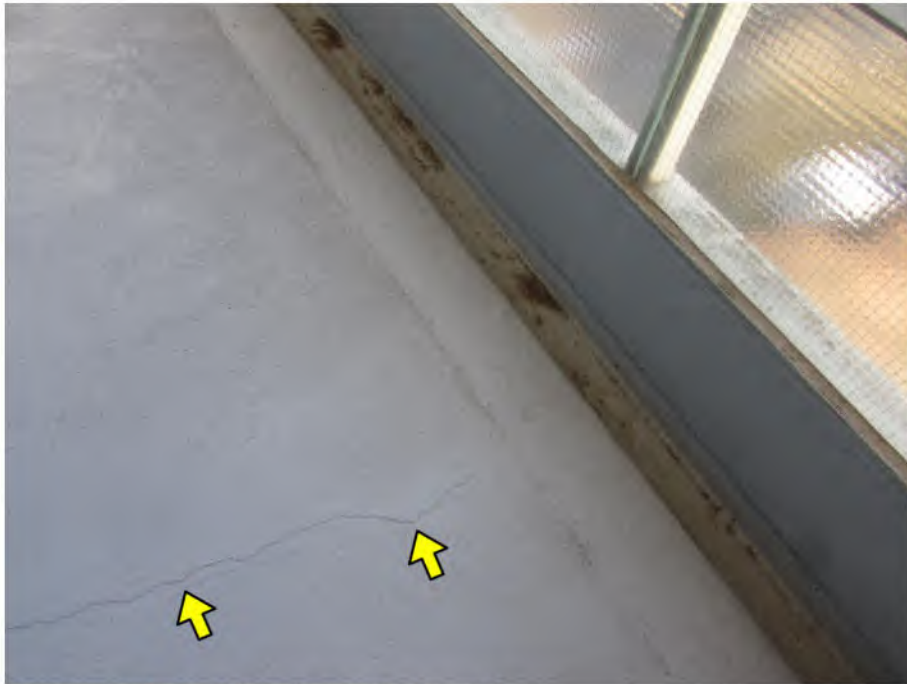
Foto 7: Balkon: Risse im Bodenbereich
