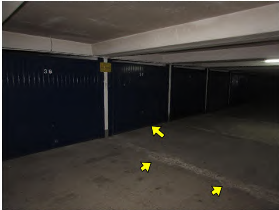
Foto 11: Tiefgarage, obere Ebene: tlw. schadhafter Betonboden Garagenbox Nr. 37
