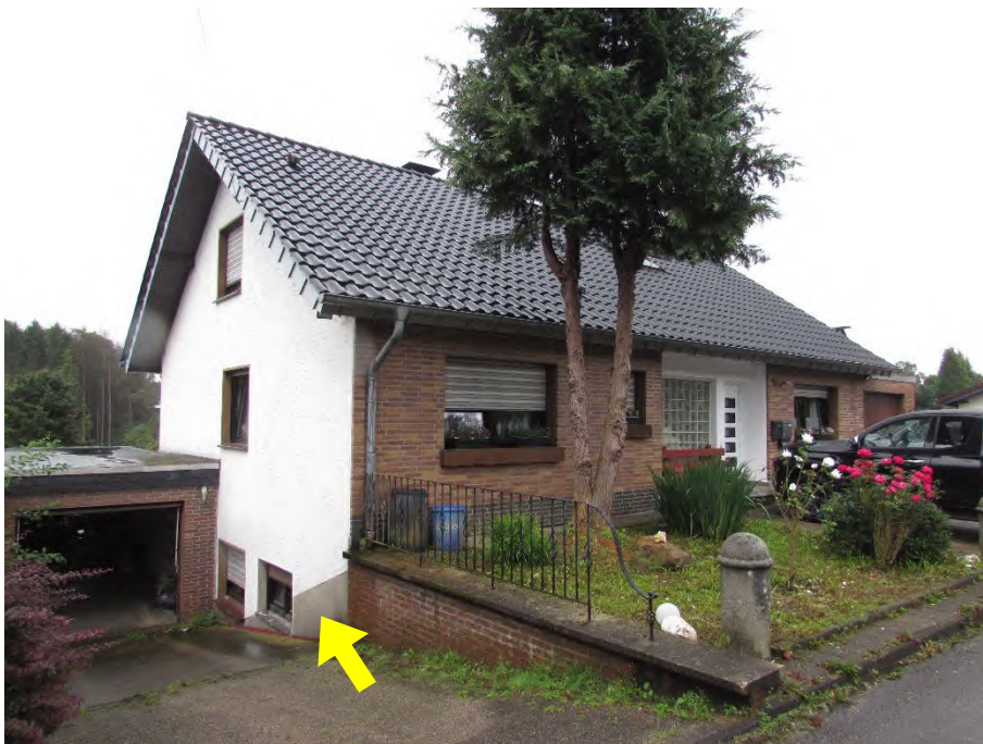
Foto 6: Garage 2 und Wohnhaus, Nordwest-Ansicht: tlw. nicht ordnungsgemäßer Fassadenputz/-anstrich
