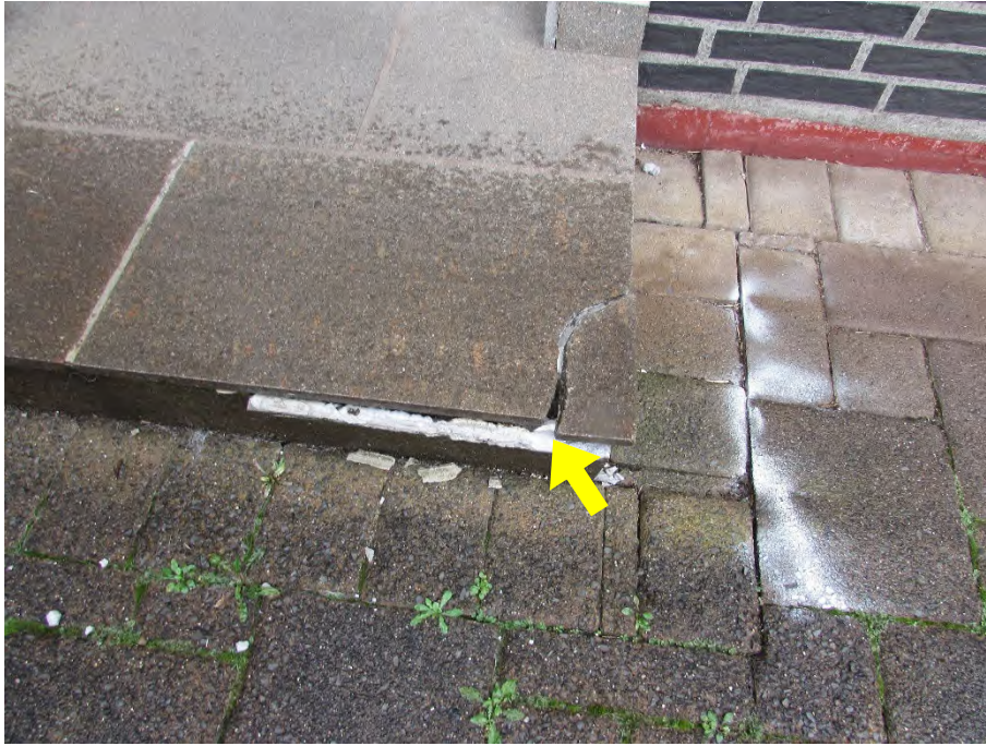
Foto 3: Hauseingangspodest: beschädigter Belag
