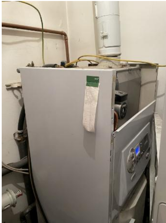
Gastherme im Hausanschlussraum
