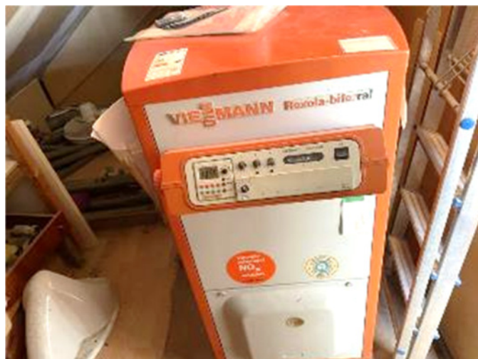
Heizungsanlage im Dachgeschoss
