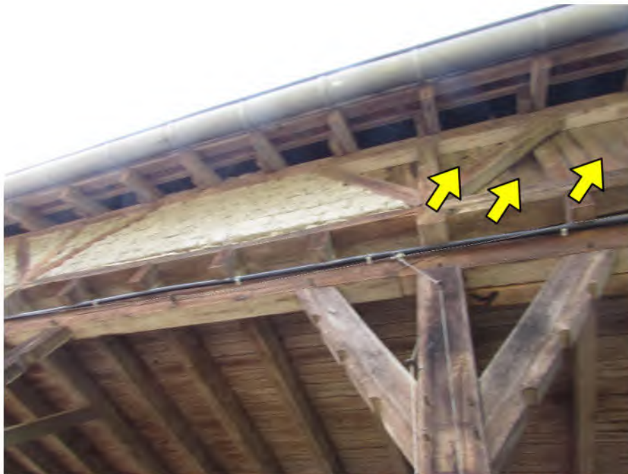
Foto 12: Remise: fehlende Fachwerkausfachung bzw. -verkleidung
