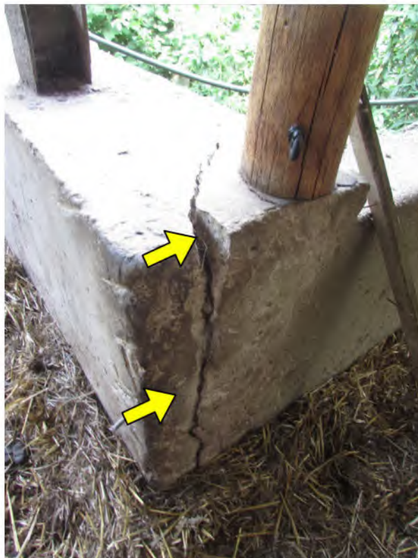
Foto 16: überdachte Dunglagerstätte: gerissener seitlicher Sockel
