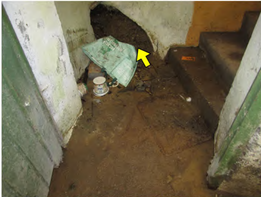
Foto 7: Wohn-/Stallgebäude, Kelleraußentreppe: Loch in der Stützwand, mit austretendem Wasser
