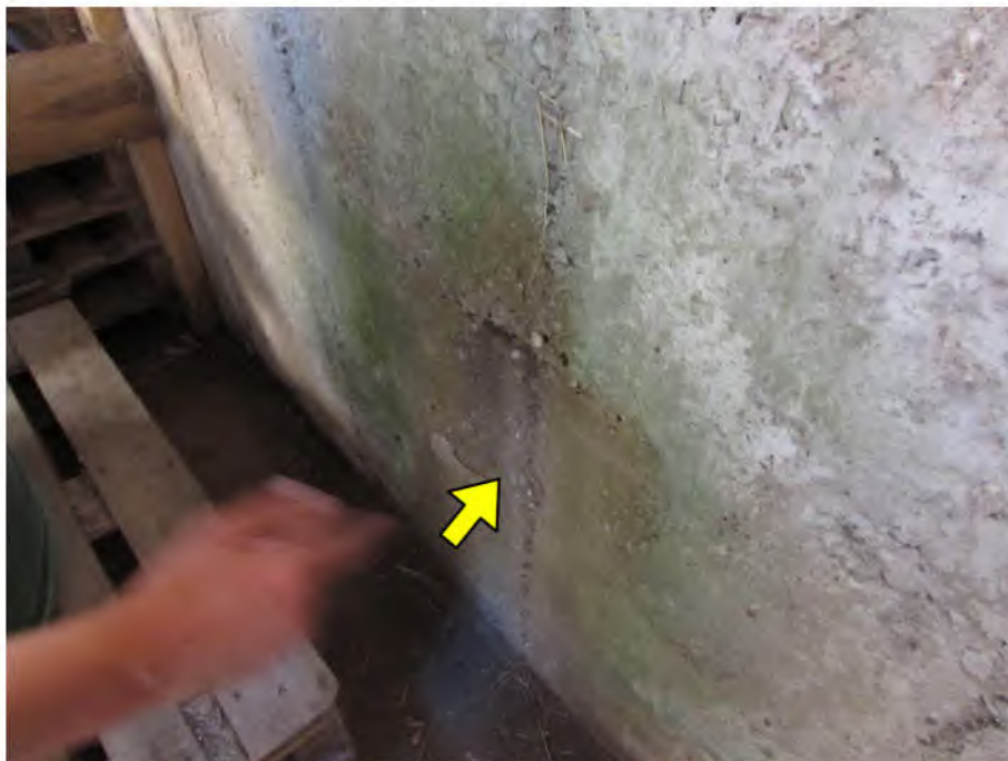
Foto 24: Scheunengebäude, Zugang mit Betonanfahrrampe: Wasseraustrittsstelle bei Regen
