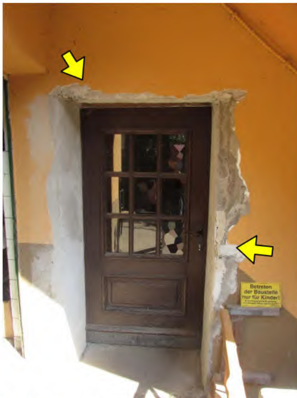
Foto 8: Wohn-/Stallgebäude, Erdgeschoss, Zugang zum Vorraum: beschädigter Wandputz im Türлаибungsbereich
