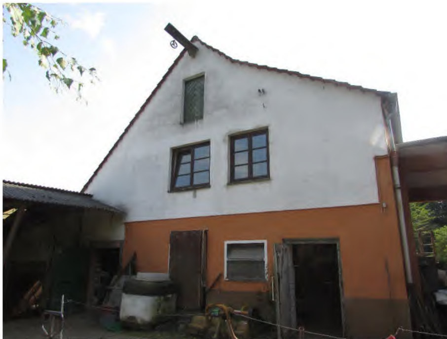
Foto 4: Wohn-/Stallgebäude, Nordost-Ansicht: fleckige Putzfassade
