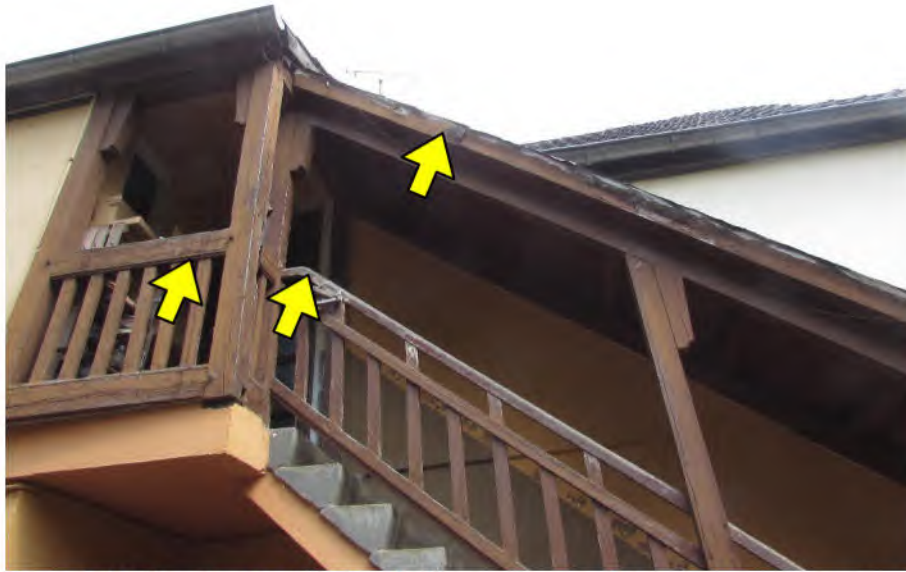
Foto 3: Wohn-/Stallgebäude, Außentreppe zur Wohnung: verwittertes Holzgeländer und -überdachung
