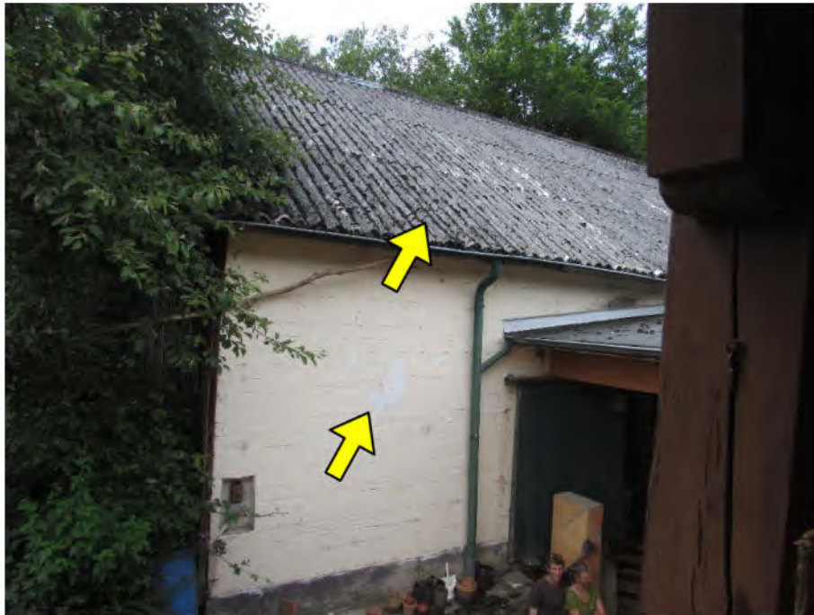
Foto 21: Scheunengebäude: verwitterte Wellasbestzementplatten-eindeckung, abblätternder Fassadenanstrich
