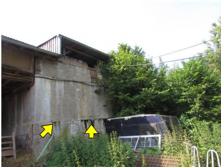
Foto 18: Bereich des Jauchekellers unterhalb der überdachten Dunglagerstätte: Undichtigkeiten im Beton
