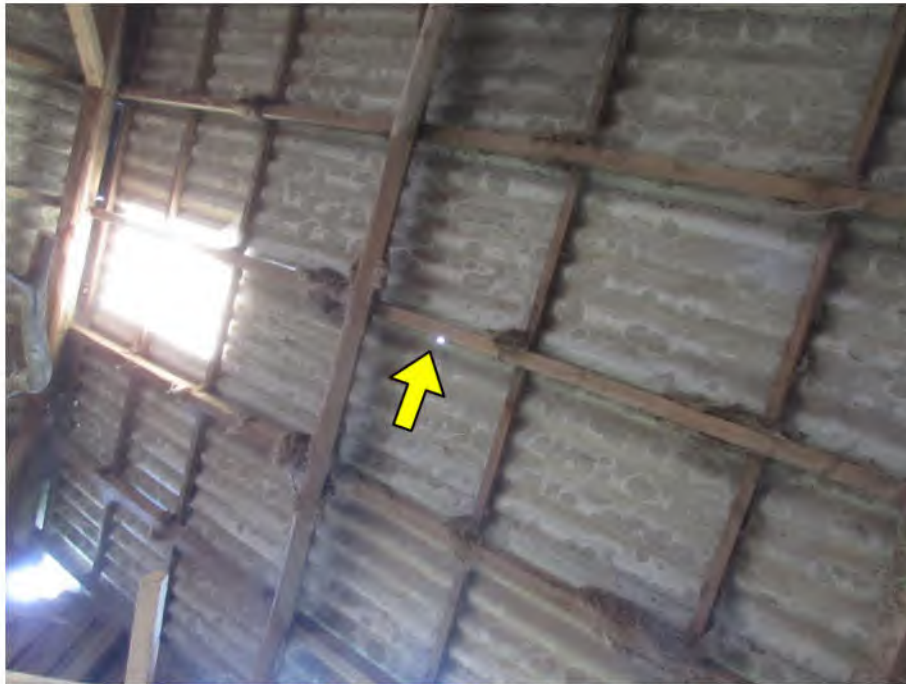
Foto 25: Scheunengebäude: tlw. undichte Dacheindeckung
