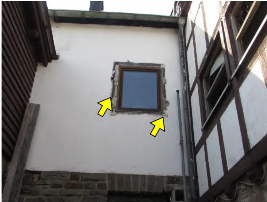
Foto 1: Flurstück 1325 , Wohn-/Stallgebäude, Südost-Ansicht: schadhafter Fassadenputz im Fensterbereich
