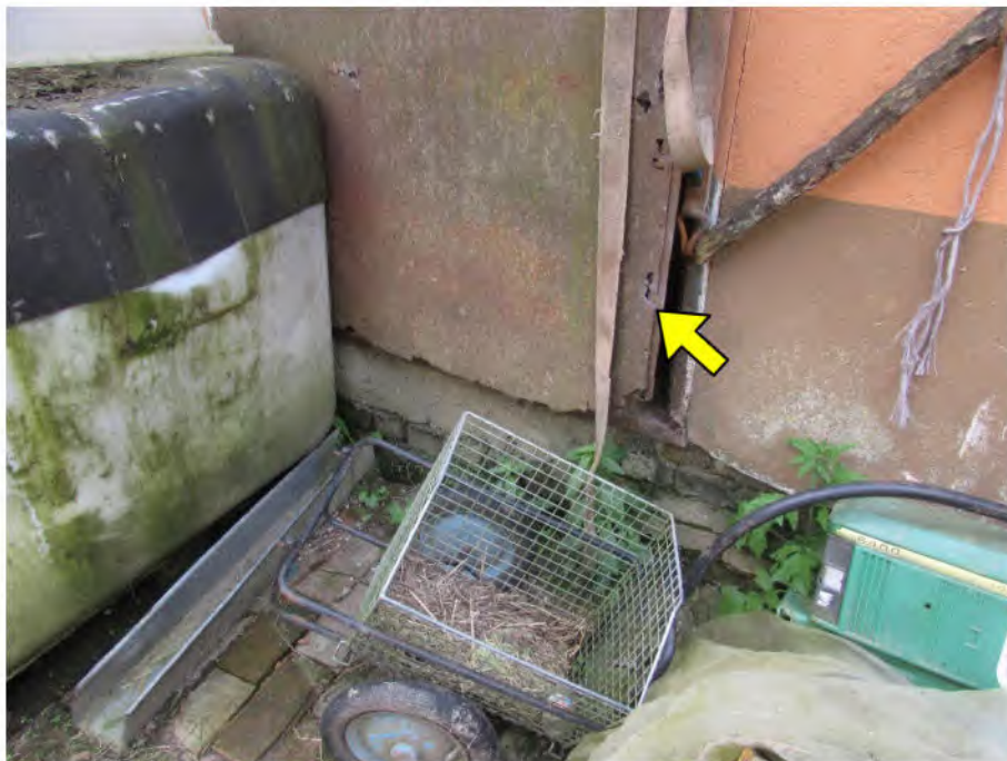
Foto 6: Wohn-/Stallgebäude, ehem. Stall: korrodierte Außentür
