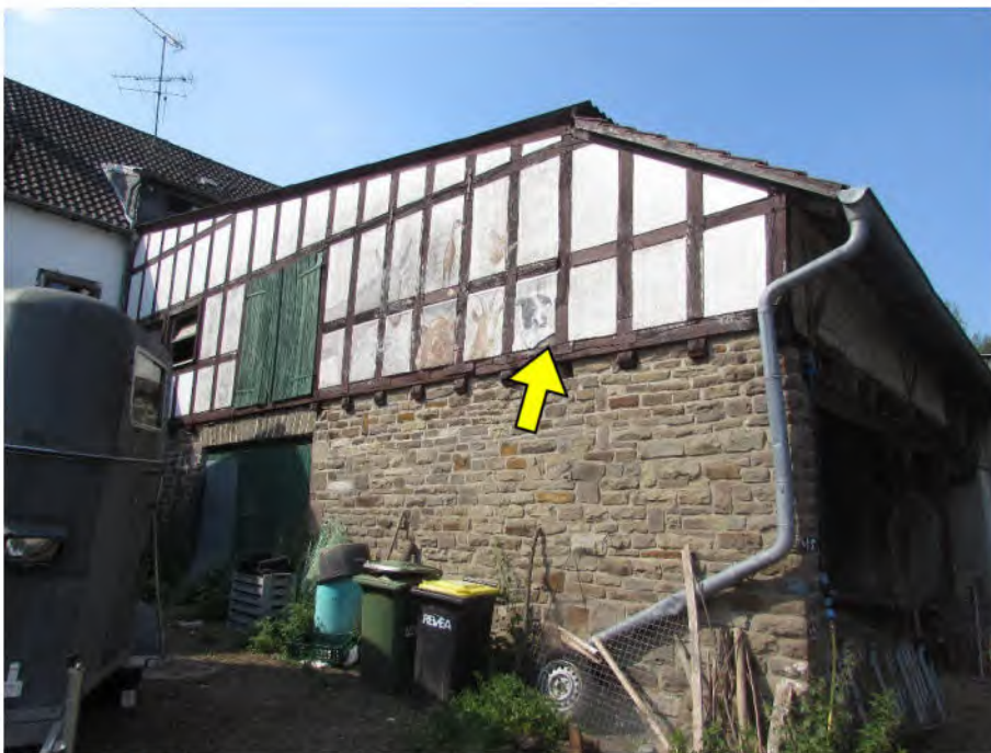
Foto 10: Schuppen mit Rübenkeller (links) und angrenzende Remise (rechts), Südwest-Ansicht: Beschädigungen im Fassadenbereich
