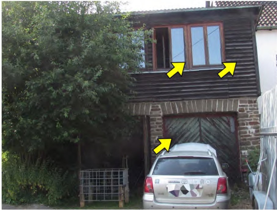
Foto 19: Garagengebäude mit aufstehendem (ehem.) Hühnerstall: verwitterte Holztore, verwitterte Holzfassadenverkleidung und verwitterte Holzfenster
