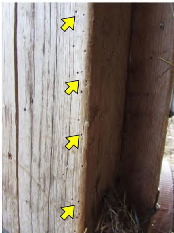
Foto 14: Remise: Holzeinbauten mit Spuren von Holzwurmbefall
