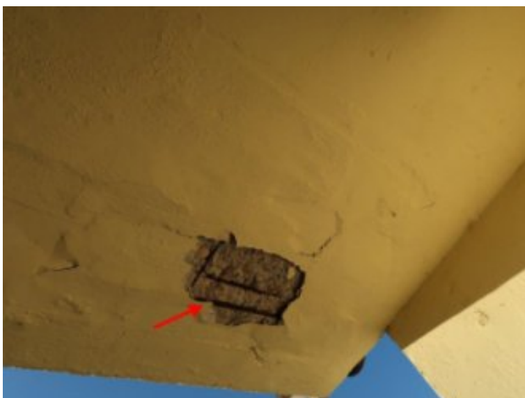
Bild 12 Schäden an den Loggien/Balkonen
