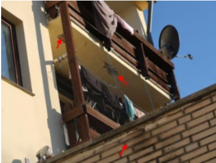
Bild 10 Schäden an den Loggien/Balkonen
