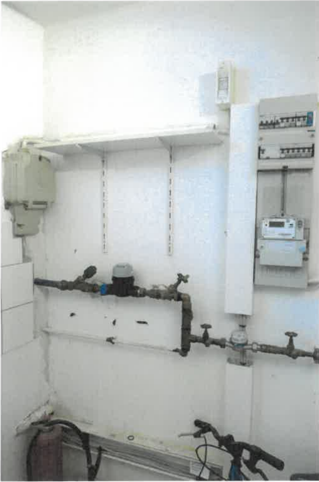
Vorratsraum (Küche) / Hausanschlüsse
