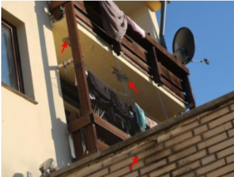
Bild 10 Schäden an den Loggien/Balkonen
