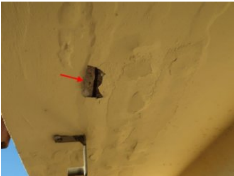
Bild 11 Schäden an den Loggien/Balkonen
