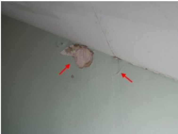
Bild 17 Putzschäden im Treppenhaus
