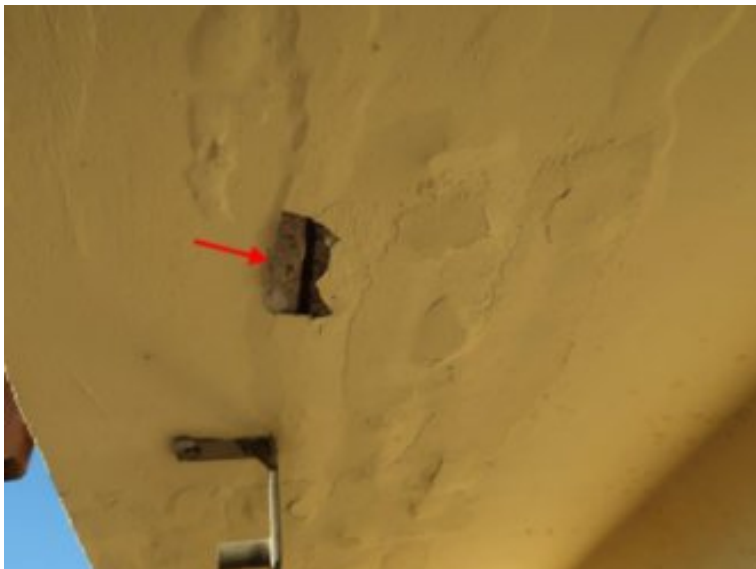
Bild 11 Schäden an den Loggien/Balkonen
