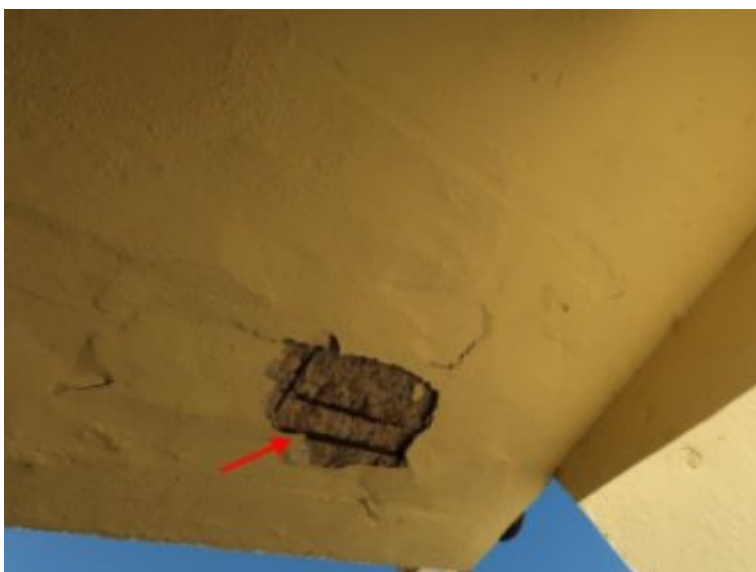
Bild 12 Schäden an den Loggien/Balkonen
