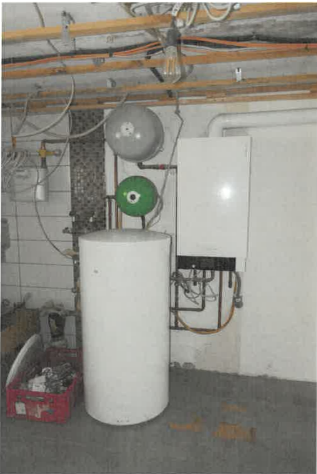
Heizungsanlage mit WW-Aufbereitung
