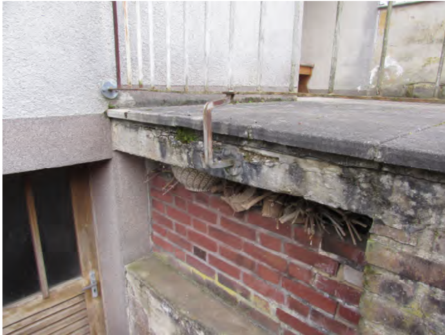
Foto 13: Schäden im Bereich der Loggia / Terrasse
