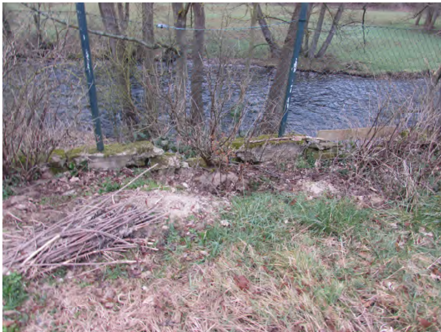
Foto 14: beschädigte Einfriedung, unterspülte Betonfundamente
