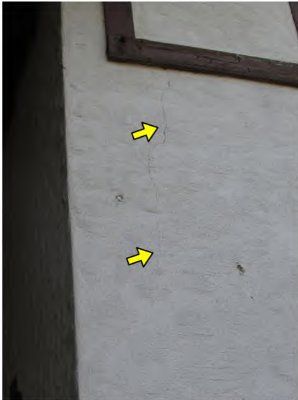
Foto 5: Wohnhaus: Putzrisse in der Fassade
