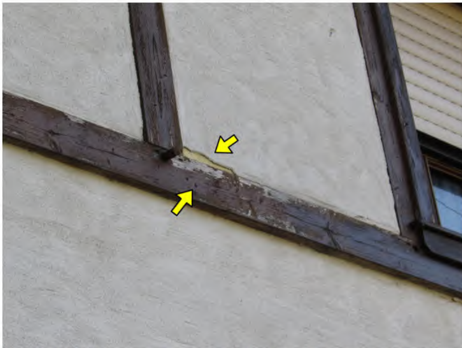
Foto 4: Wohnhaus: verwittertes, auf die Fassade aufgesetztes Holzfachwerk; Putzschäden
