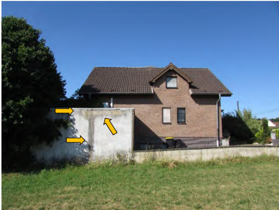
Foto 3: Wohnhaus mit PKW-Garage, Seitenansicht, Beschädigungen an der Fassade der PKW-Garage
