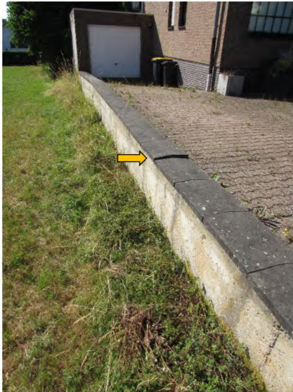
Foto 5: Wohnhaus mit PKW-Garage, uneben liegende Betonplattenabdeckung der Sockelmauer
