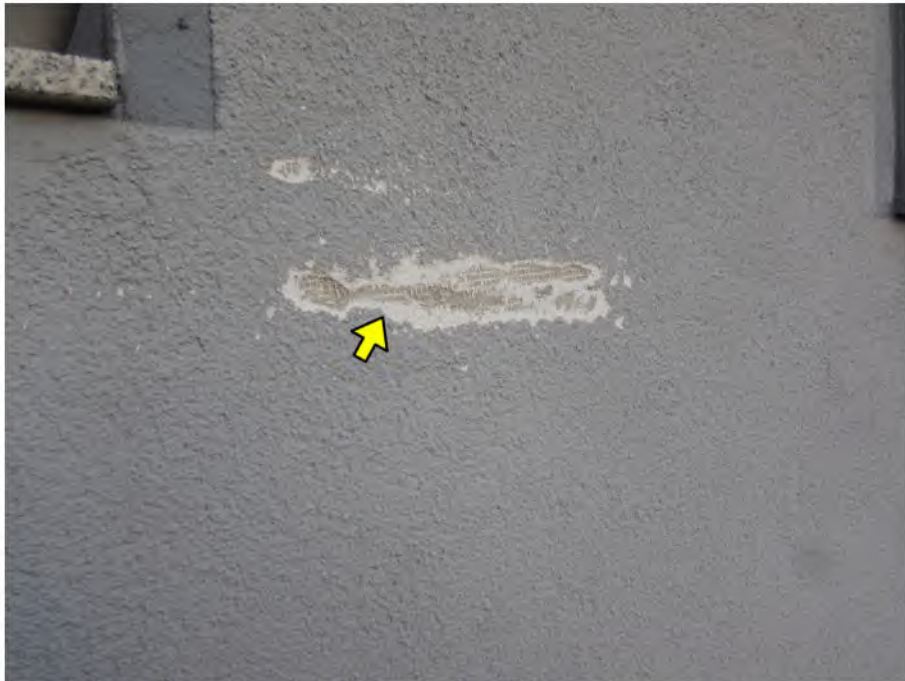
Foto 5: Wohnhaus: Beschädigungen am Wärmedämmverbundsystem der Fassade
