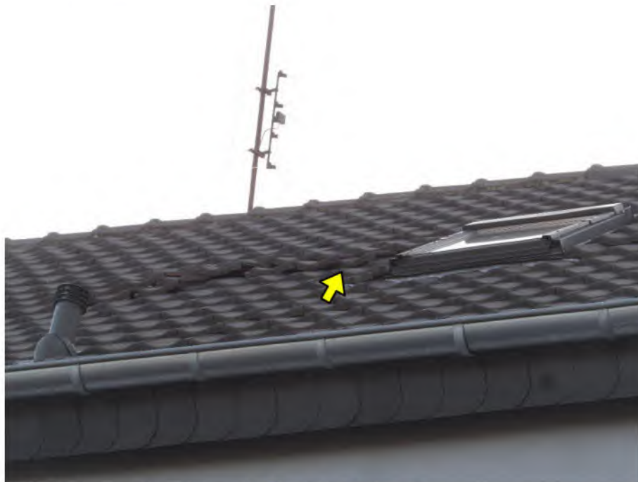
Foto 2: tlw. uneben liegende Dacheindeckung
