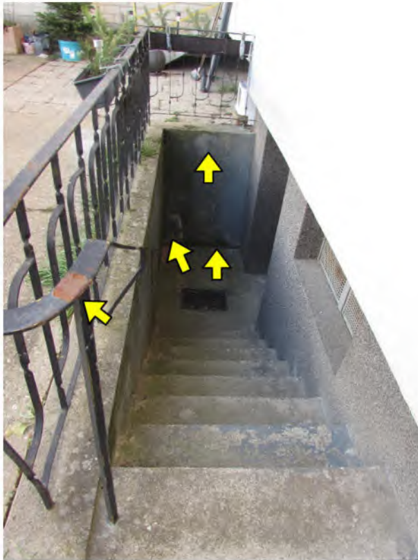
Foto 7: Kelleraußentreppe: korrodiertes Geländer, Feuchtigkeit im Stützwandbereich
