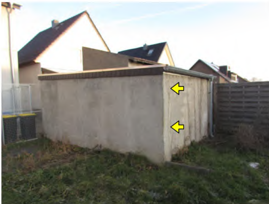
Foto 10: PKW-Garage, rückwärtige Ansicht: beschädigte Fassade
