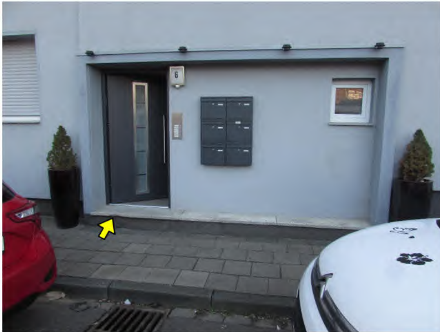
Foto 3: Hauseingang: beschädigte Eingangsstufe
