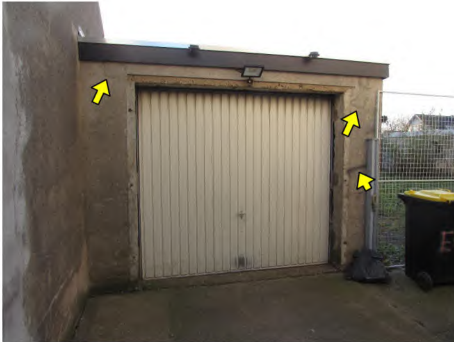
Foto 9: PKW-Garage: beschädigte Fassade
