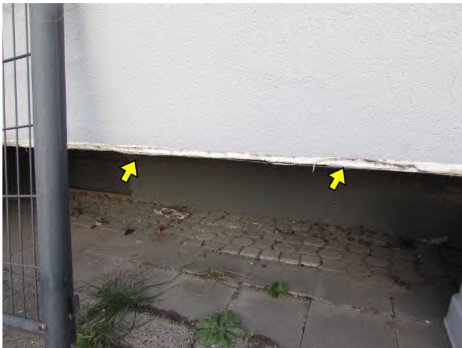
Foto 6: Wohnhaus: Beschädigungen am Wärmedämmverbundsystem der Fassade
