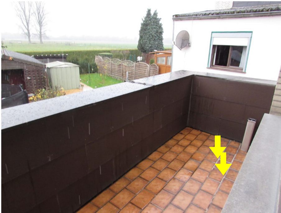
Balkon, schadhafte Bodenfliesen-Verfugung
