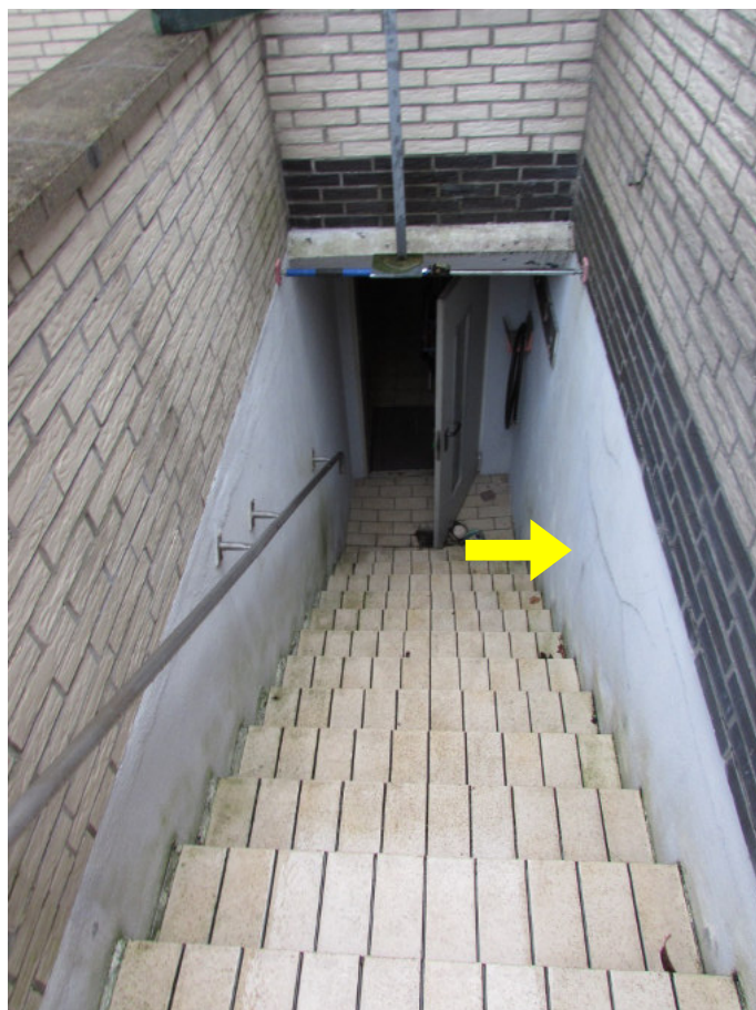
Kelleraußentreppe, Putzschäden im Stützwandbereich
