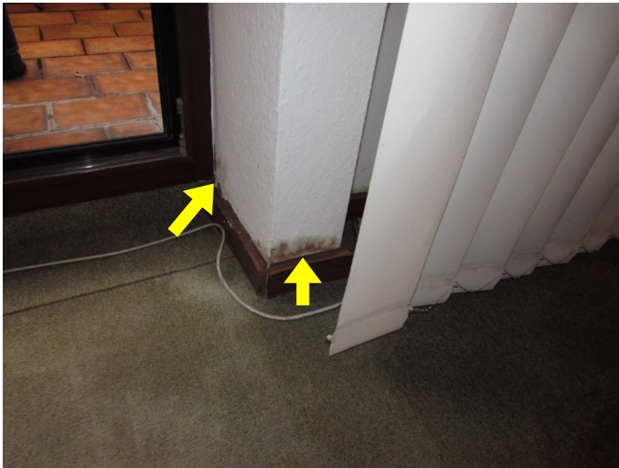
Wohnzimmer, Feuchtigkeit im Außenwandbereich, zum Balkon hin
