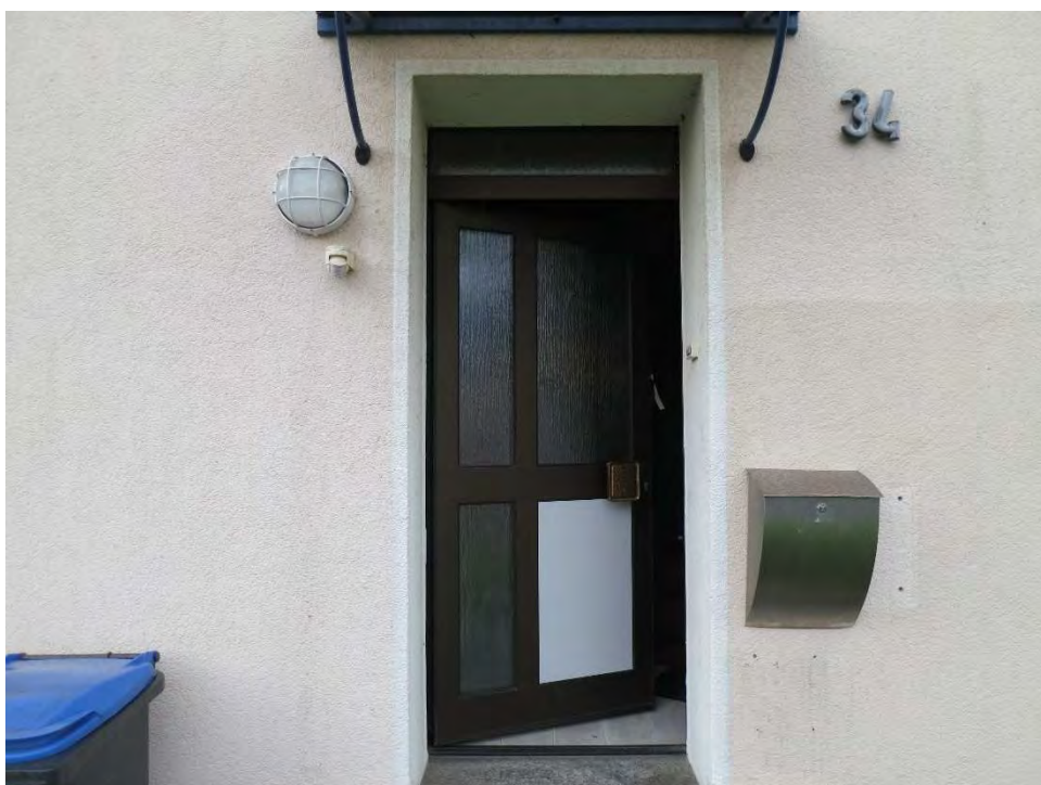
Lichtbild 4: Detail, Hauseingangstüranlage mit Glasbruchschaden und Reparaturfüllung
